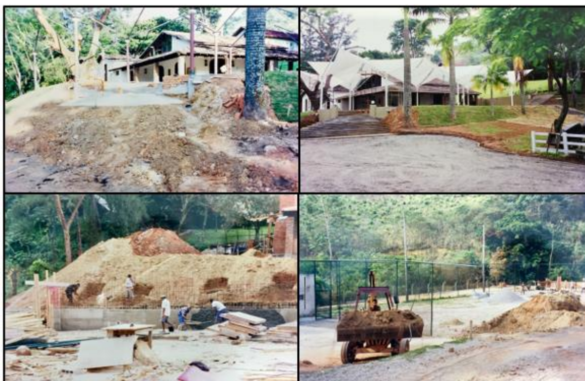
(fotos das obras de ampliação dos espaços Garden II e Garden III entre 2003 e 2004)
