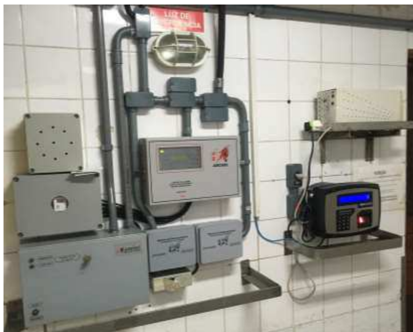
Foto 023: Sistema elétrico e relógio de ponto.
