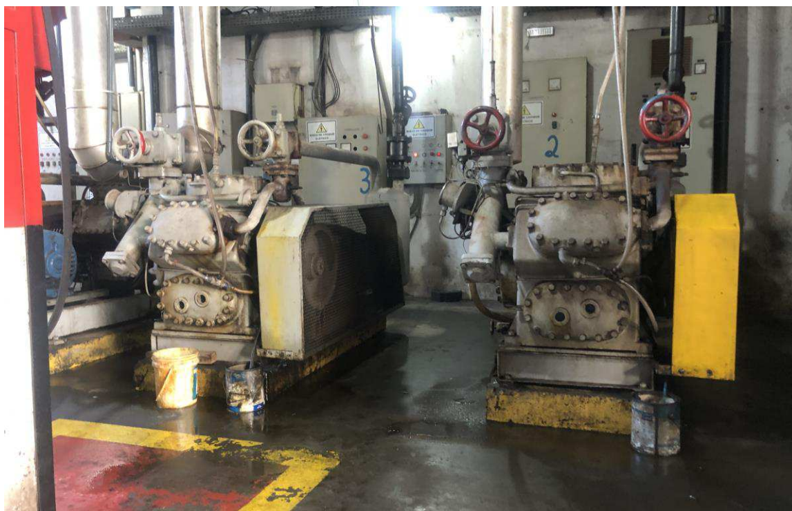
Foto 021: Setor hidráulico da empresa
