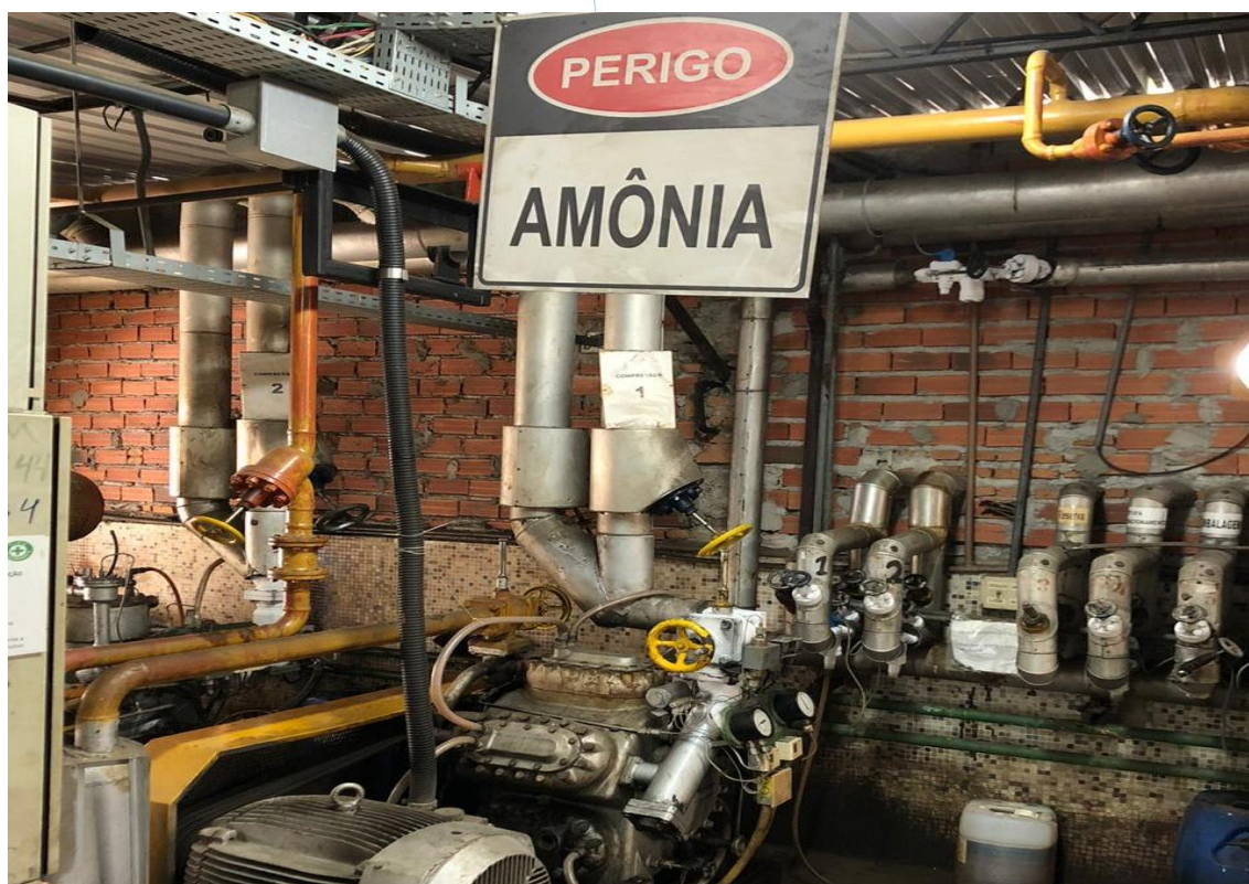
Foto 040: Sala de máquinas
