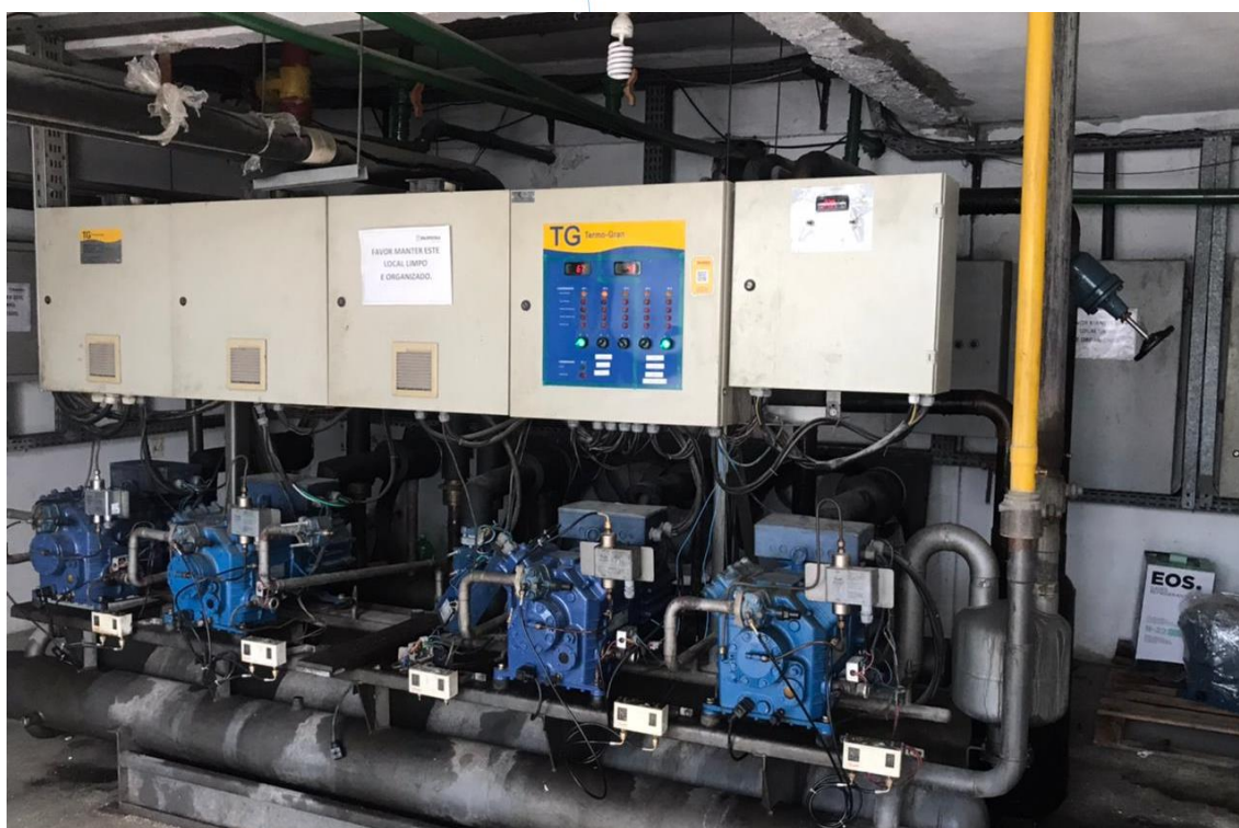
Foto 017: Sala de Máquinas
