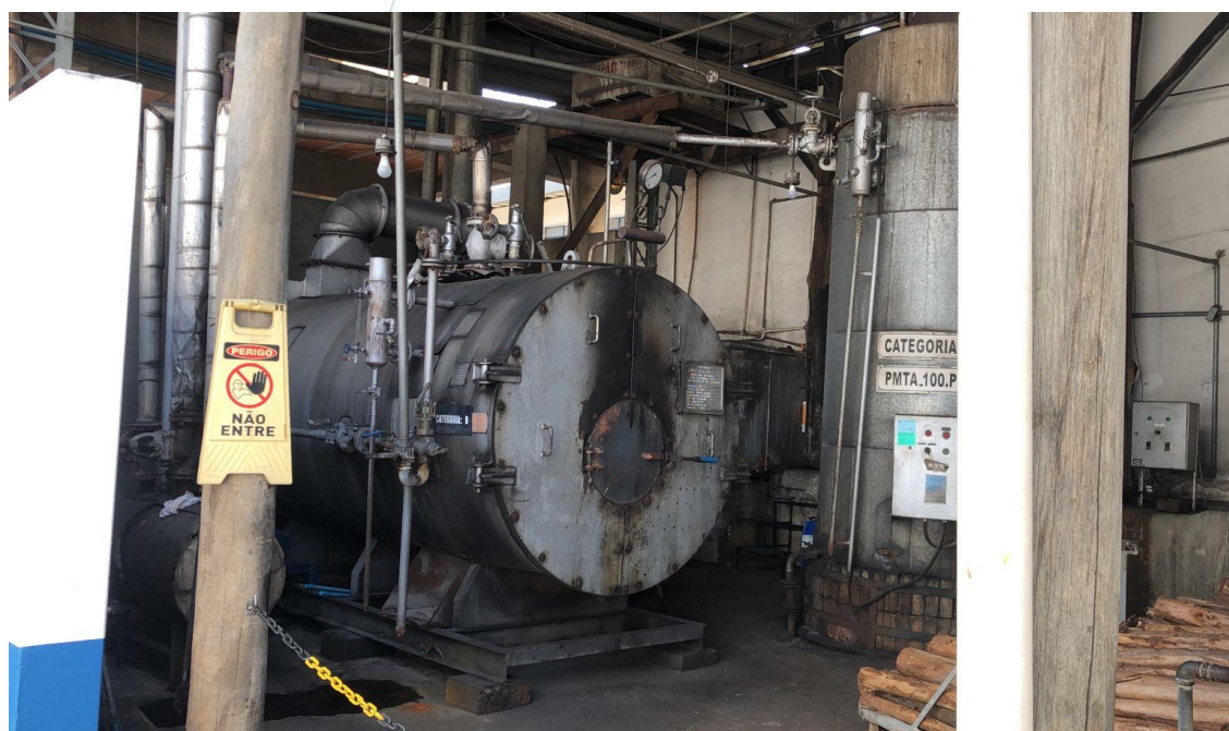
Foto 032: Caldeira para aquecimento da água
