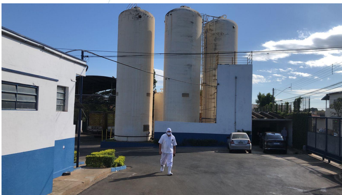
Foto 027: Tanques de abastecimento
