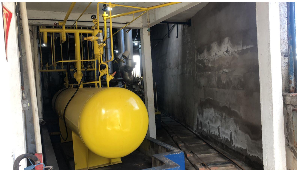
Foto 021: Tanque de amônia
