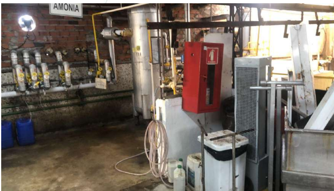
Foto 092: Setor de refrigeração
