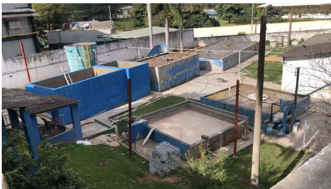
Foto 050: Estação de tratamento de afluentes da empresa
