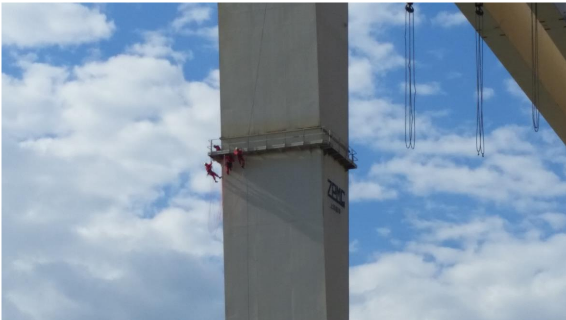
Alpinismo pórtico 600 ton – Levantamento de pontos de corrosão
