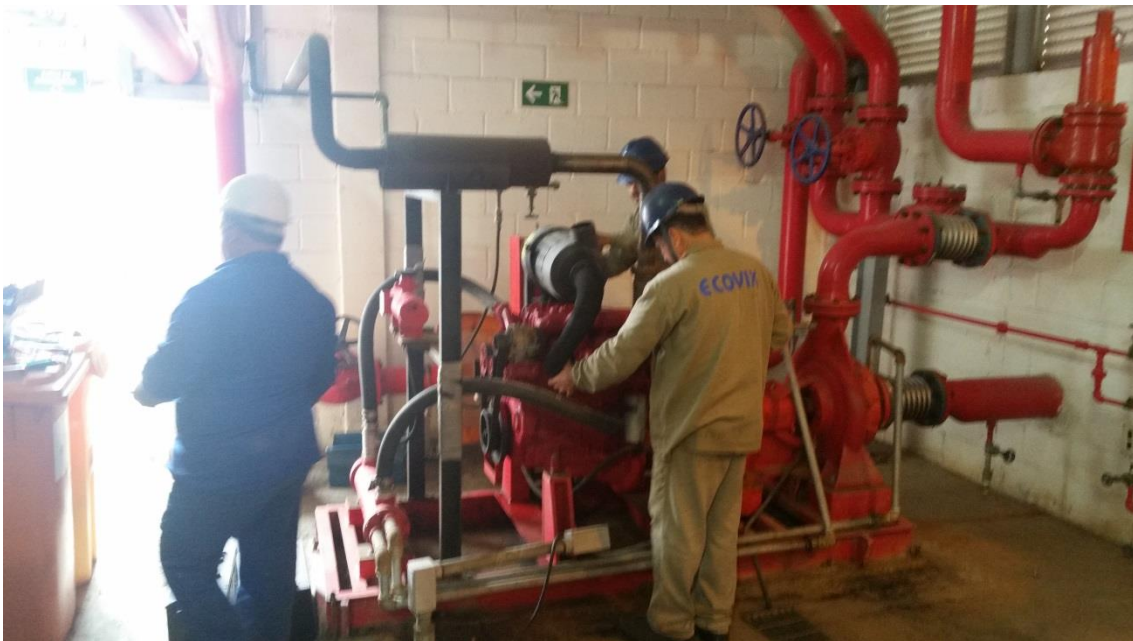
Manutenção Sistema de Combate a Incêndio
