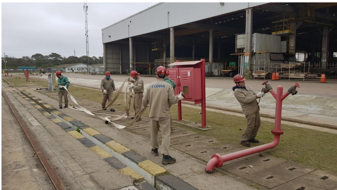
Manutenção e Testes – Sistema de Combate Incêndio
