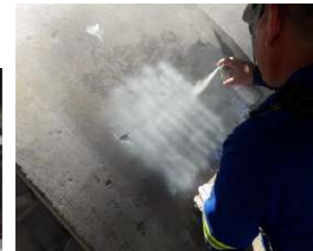
Controle do aquecimento
