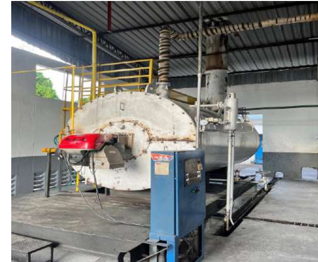
Caldeira a gás
