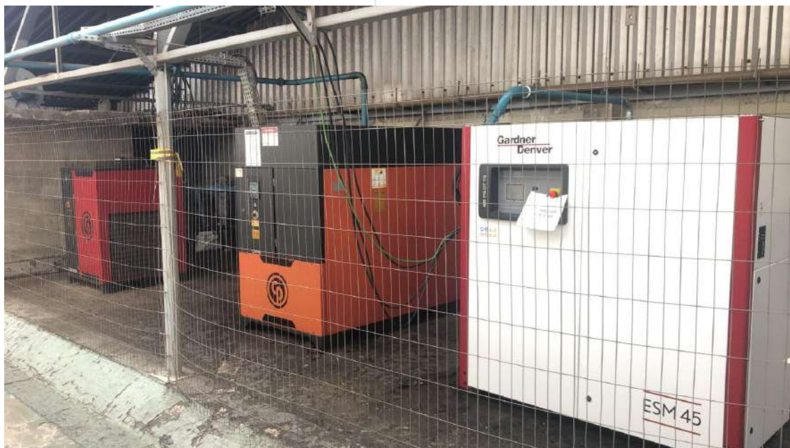
Foto 037: Hall de Serviços ( motores de máquinas em operação )
