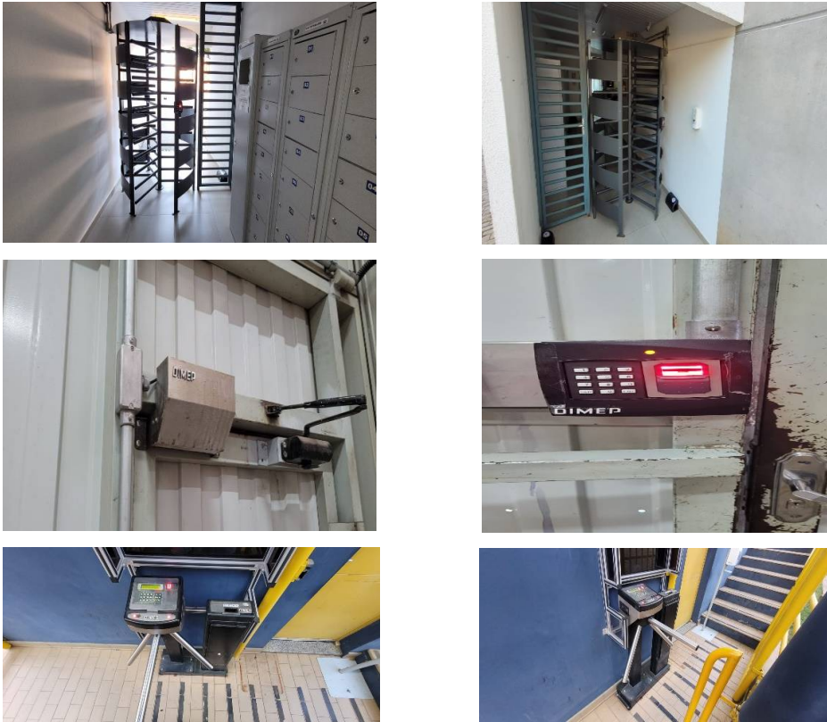
Figura 05 - Equipamento para Controle de Acesso
