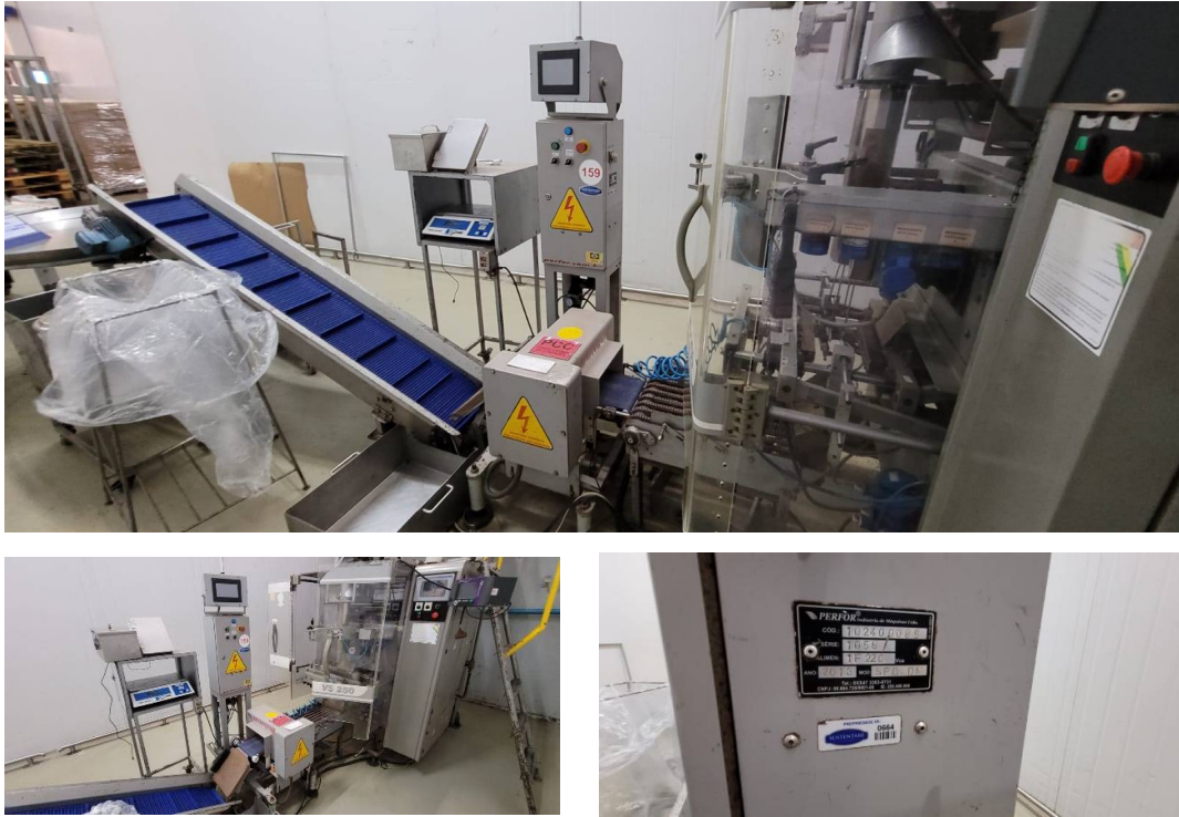
Figura 19 - Sistema controlador peso e detecção de metais – Linha 5232
