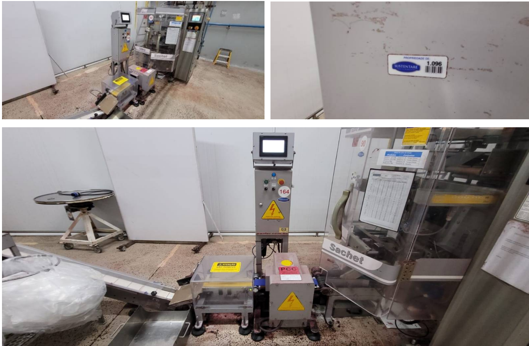
Figura 15 - Sistema controlador peso e detecção de metais – Linha 5213
