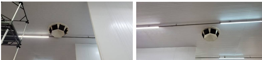
Figura 02 - Conjunto de Exaustores e Insufladores
