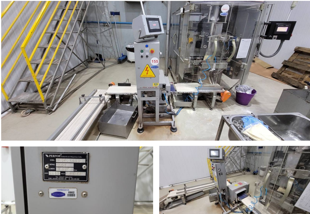
Figura 20 - Sistema controlador peso e detecção de metais – Linha 5234
