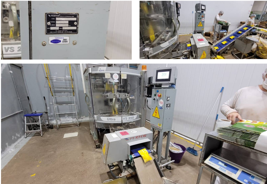
Figura 18 - Sistema controlador peso e detecção de metais – Linha 5221
