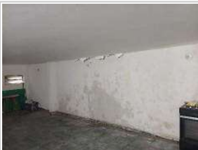
SALA DE JOGOS - UMIDADE EM PAREDE
