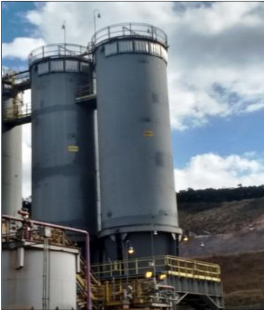
2243688 SILO DE AMIDO 11BNOP16
