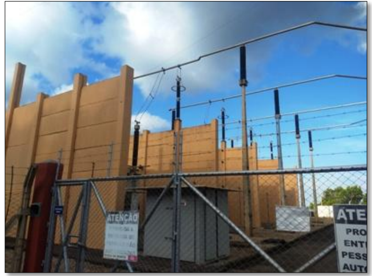
2240902 LINHA DE TRANSMISSÃO LT 345 KV -37 KIL -REDE BAS
