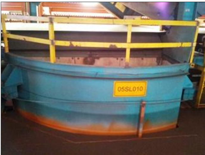
2166843 SILO DO PELOTAMENTO, EM ACO CARBONO
