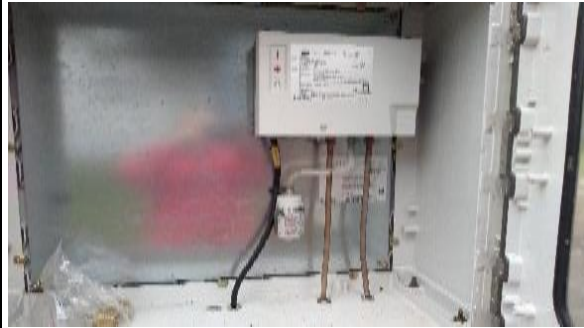
- MEDIDOR DE PRESSÃO -
