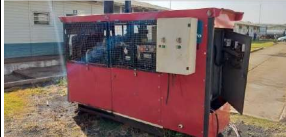
- GERADOR DE ENERGIA -
