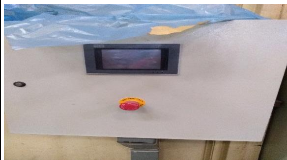
- PAINÉIS DE COMANDO DOS OPERADORES DAS SERRAS (NR10) -
