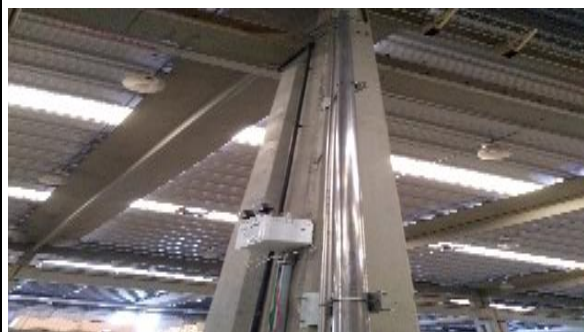
- TUBULAÇÃO DE SUPRIMENTO DO SISTEMA DE BOMBEAMENTO -
