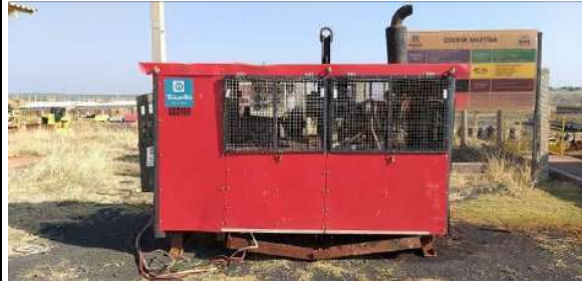
- GERADOR DE ENERGIA -
