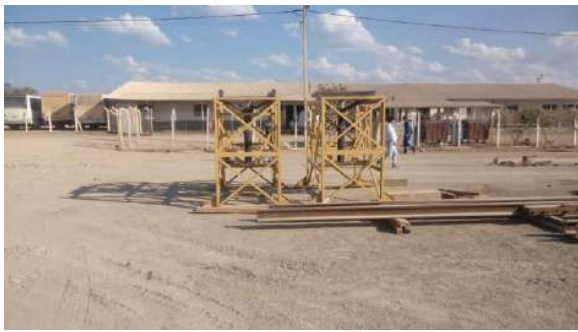
- EQUIPAMENTOS DA FÁBRICA DE DORMENTES -
