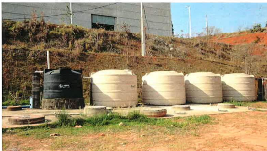
Foto 25 – Foto dos Bio Digestores -
