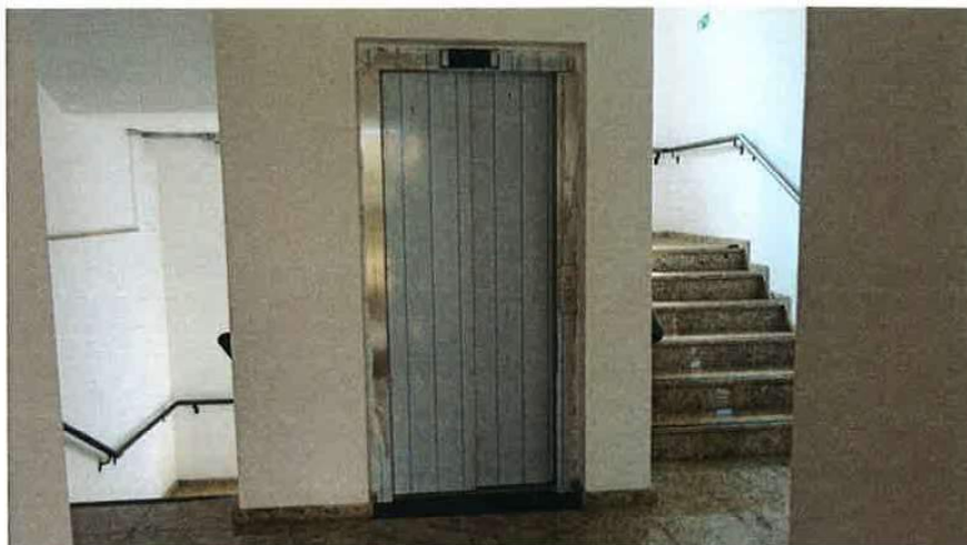
14 – Elevador de acesso a área Administrativa.
