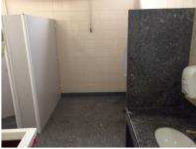
Banheiro padrão (5º andar)
