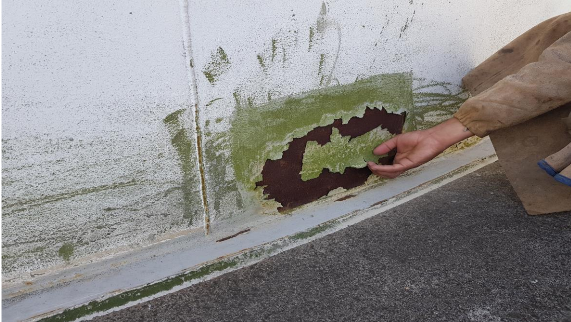
Tanque B – Água Potável - Oxidação
