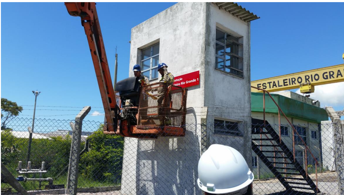
Manutenção Subestação 69 kV
