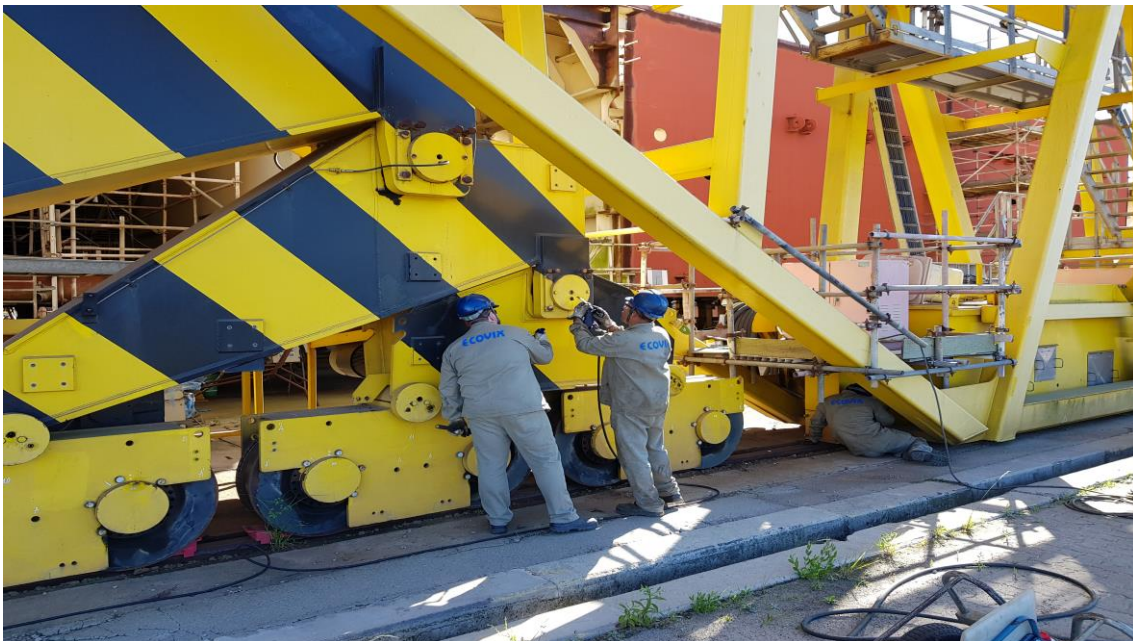
Lubrificação Pórtico 2.000 ton
