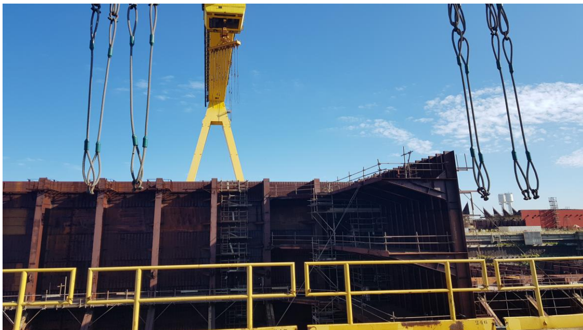
Manutenção e testes Pórtico 2000 ton
