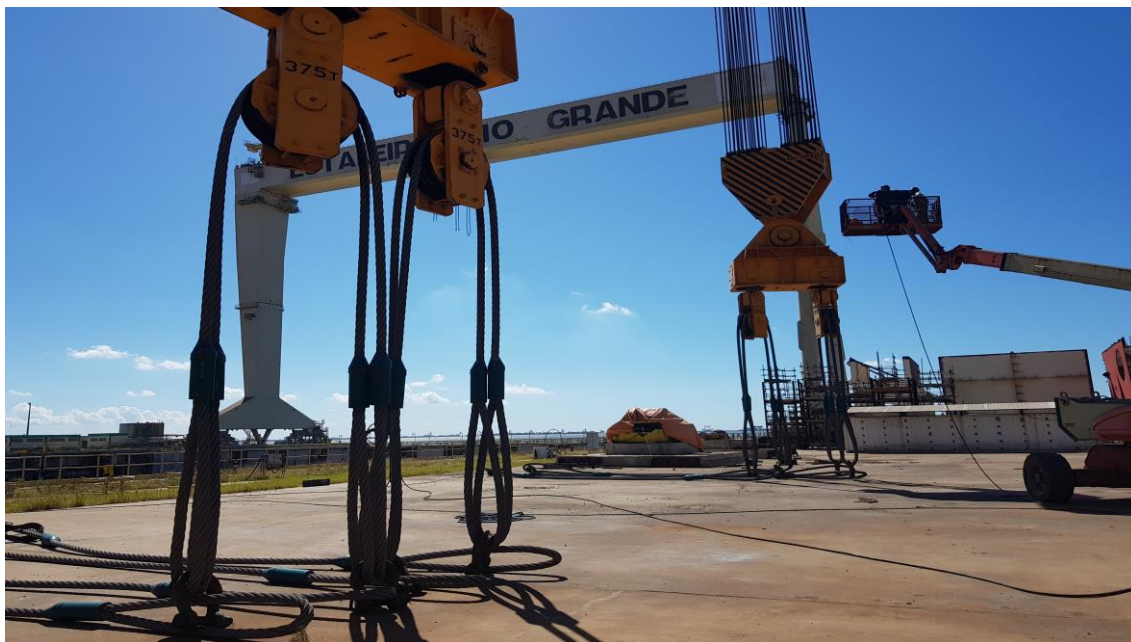
Lubrificação Pórtico 2.000 ton
