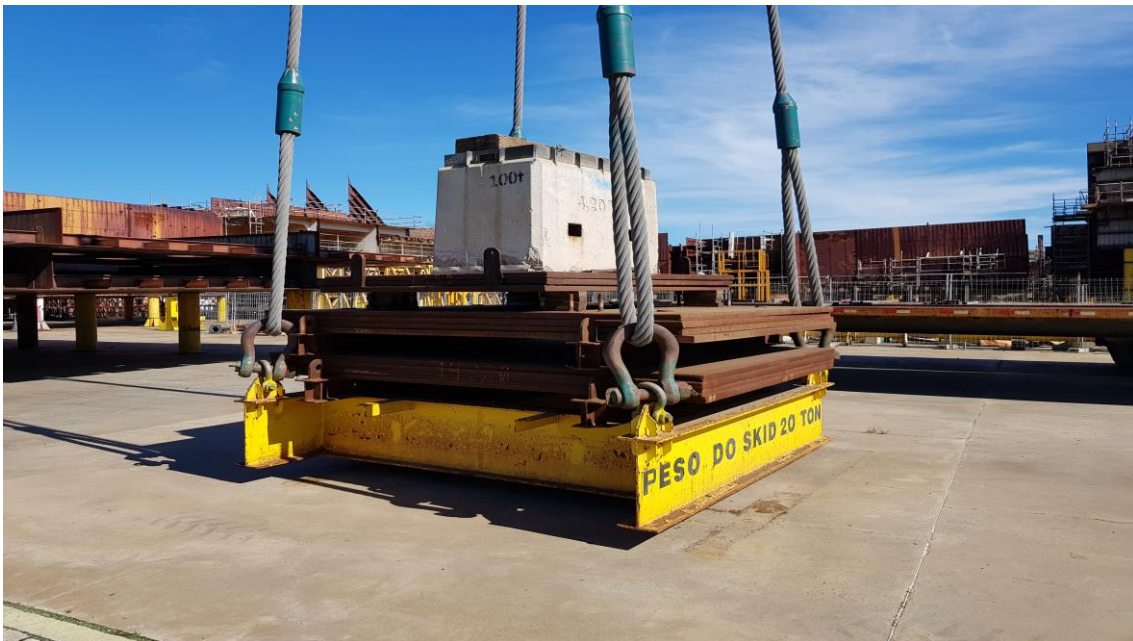
Manutenção e testes Pórtico 2000 ton
