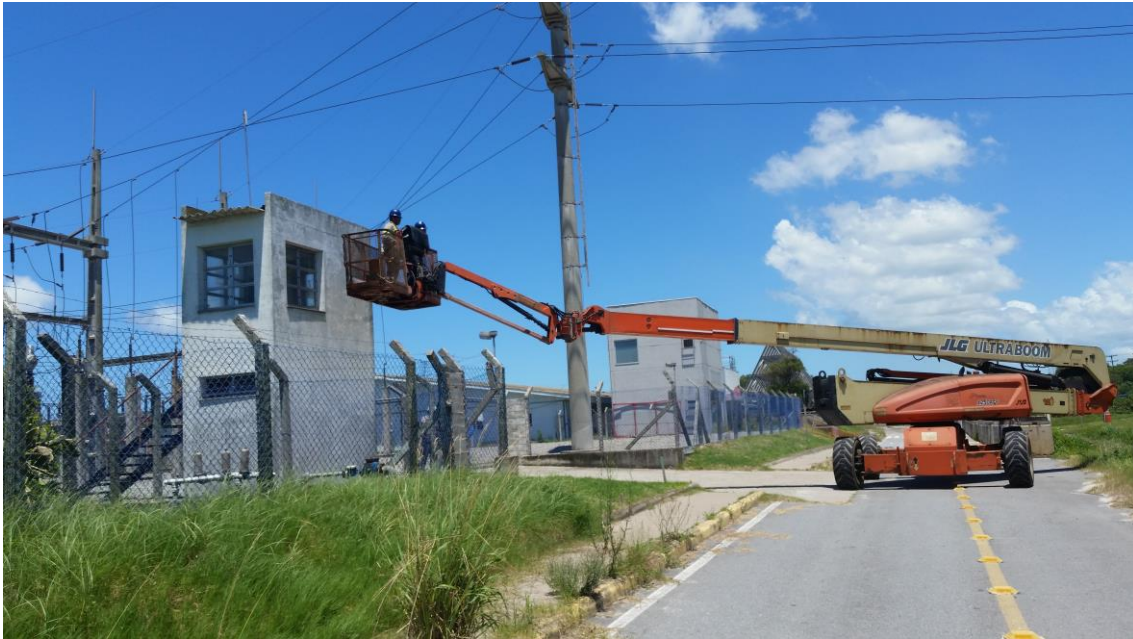
Manutenção Subestação 69 kV
