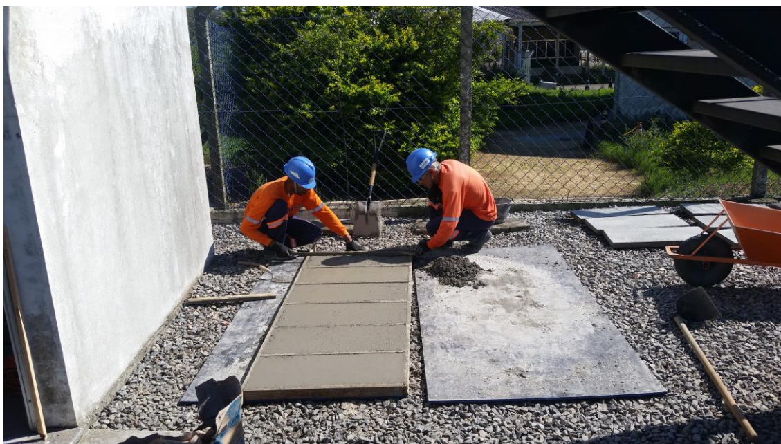
Manutenção Subestação 69 kV
