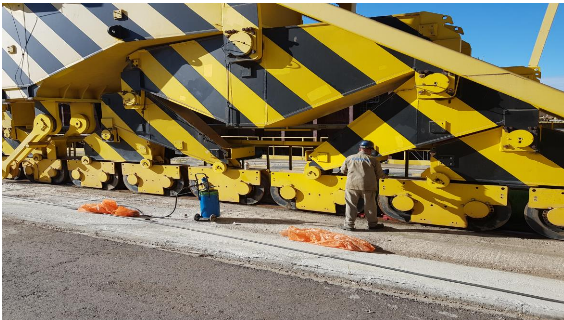
Lubrificação Pórtico 2.000 ton
