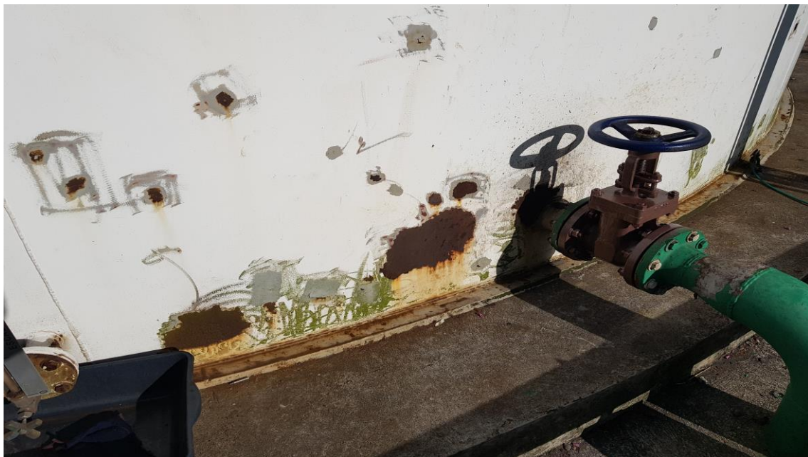
Tanque B – Água Potável – Oxidação
