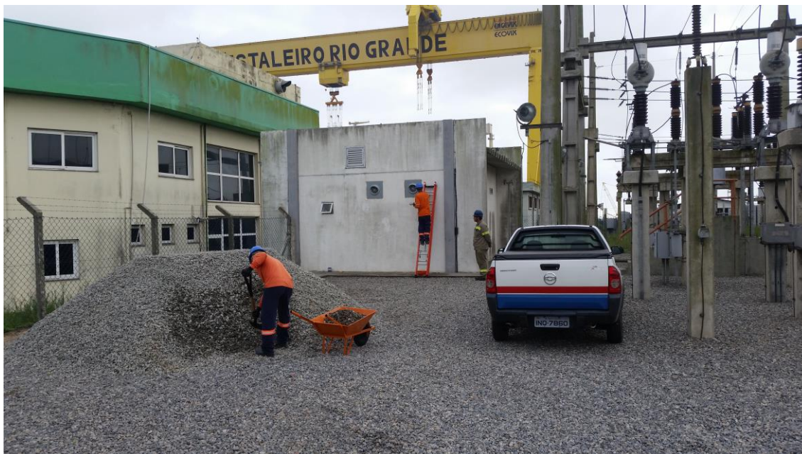
Manutenção Subestação 69 kV
