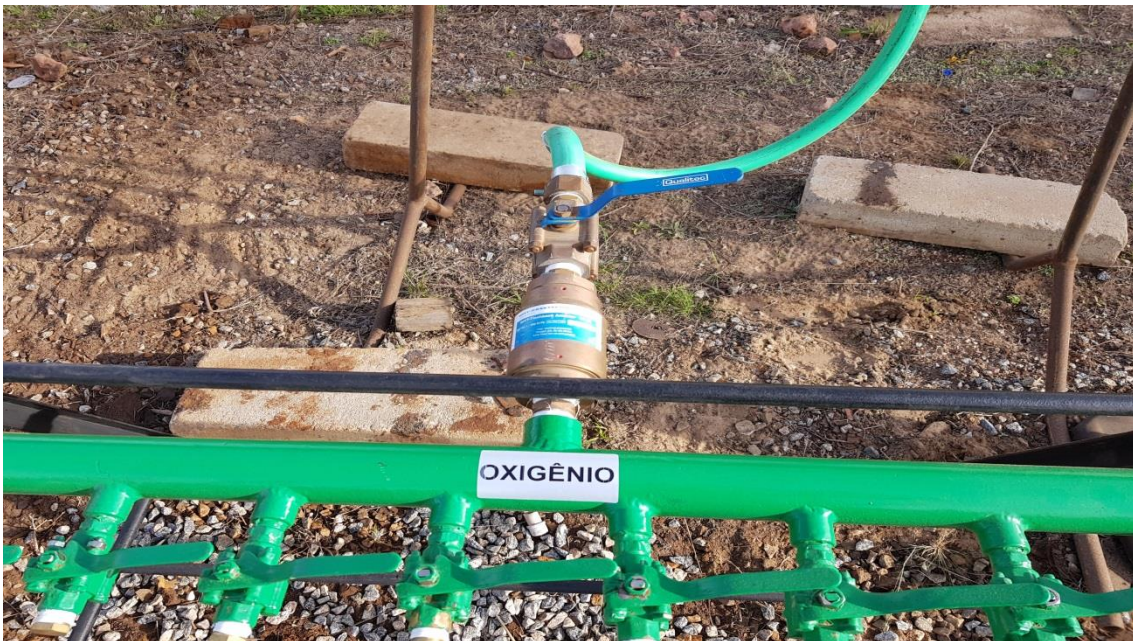
Manutenção Rede de Gases – Manifolds
