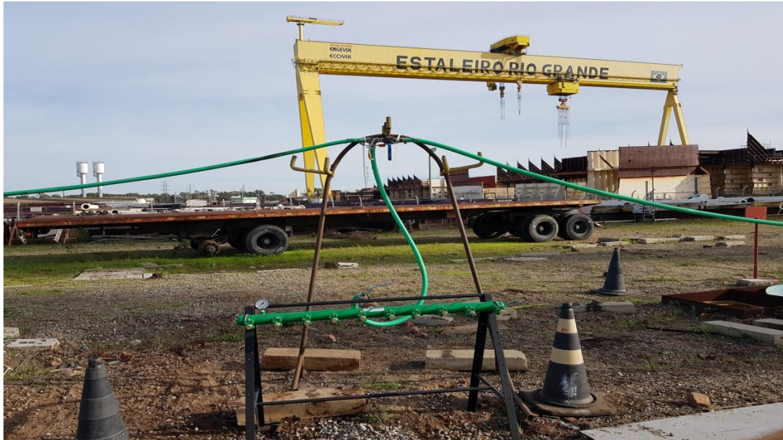
Manutenção Rede de Gases – Manifolds
