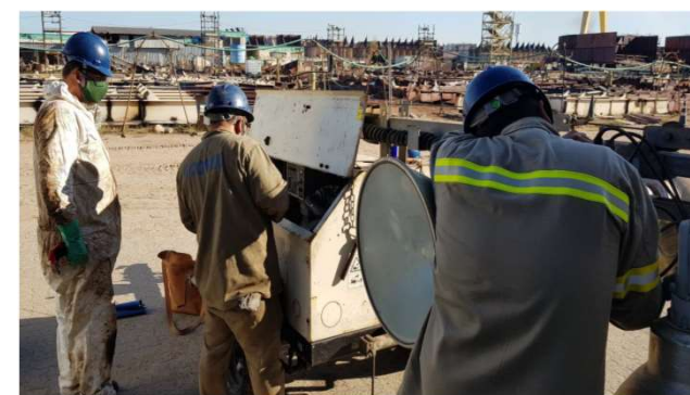
Iluminação apoio corte de sucata
