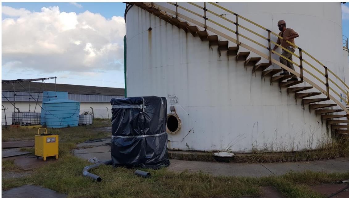
Manutenção Equipamentos – Tanques
