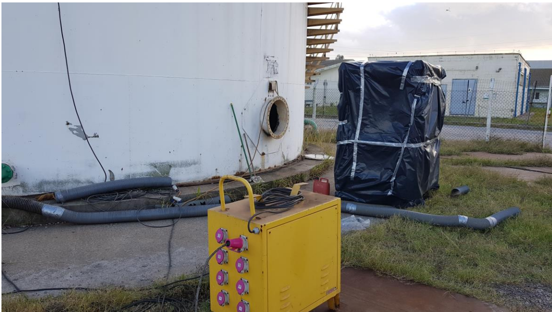
Manutenção Equipamentos – Tanques
