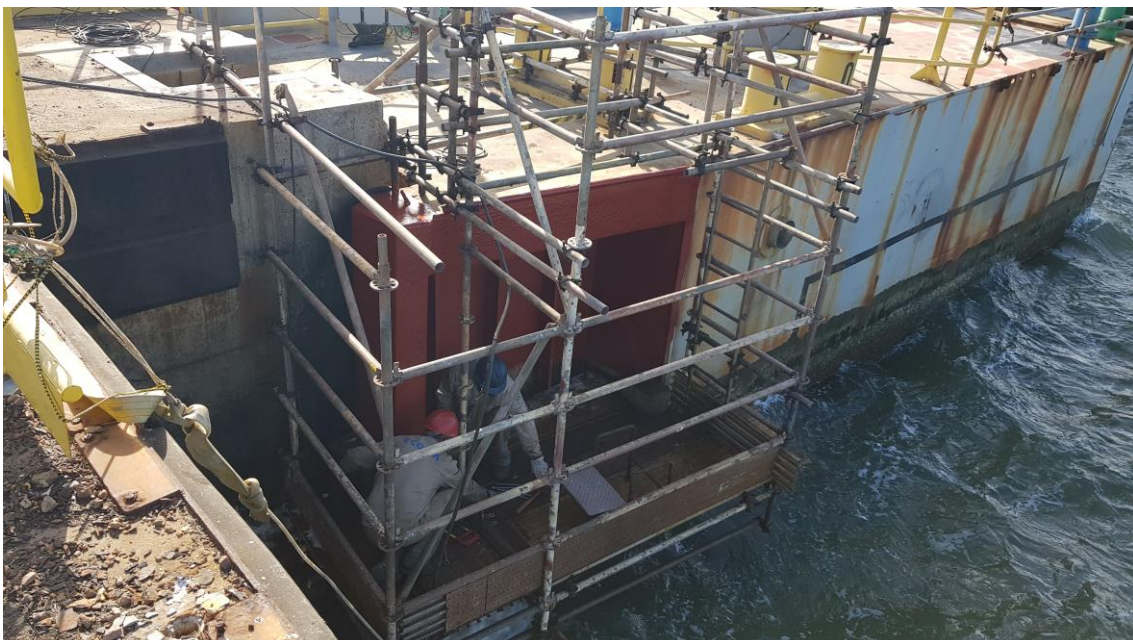
Manutenção Equipamentos – Porta Batel
