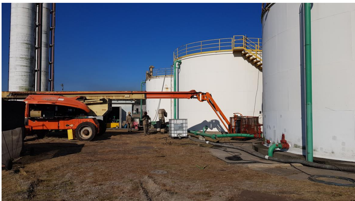
Manutenção Equipamentos – Tanques
