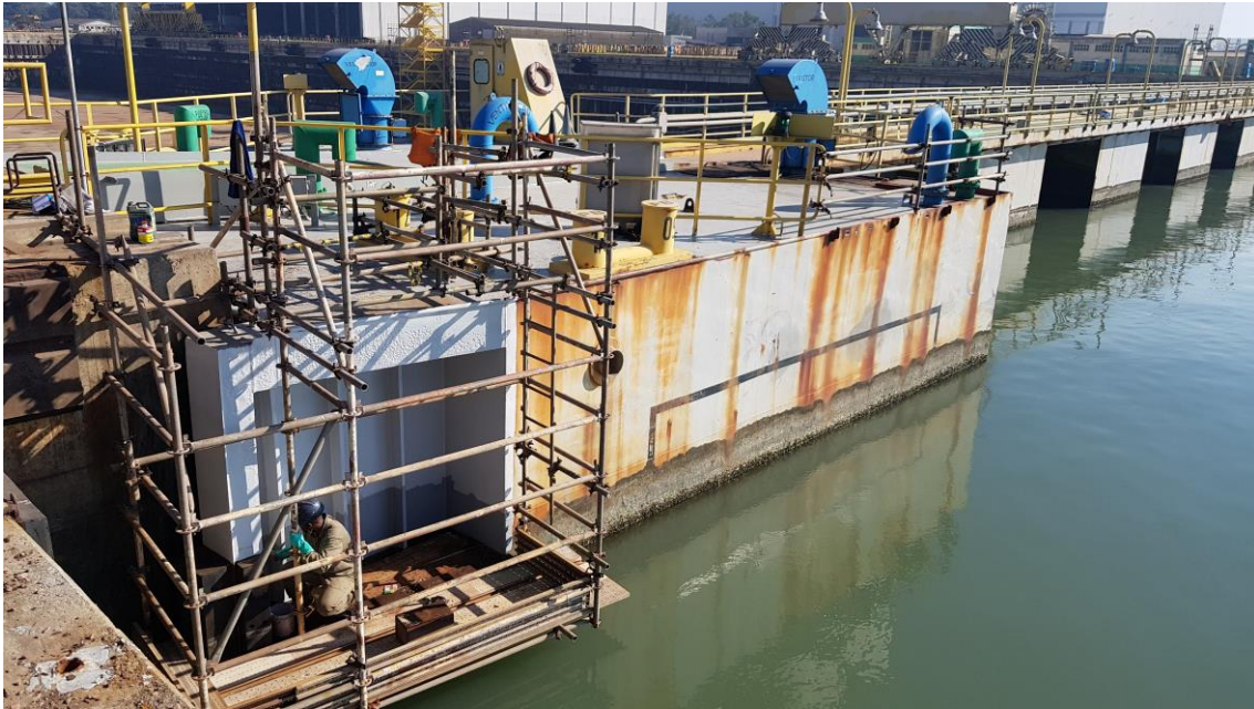
Manutenção Equipamentos – Porta Batel
