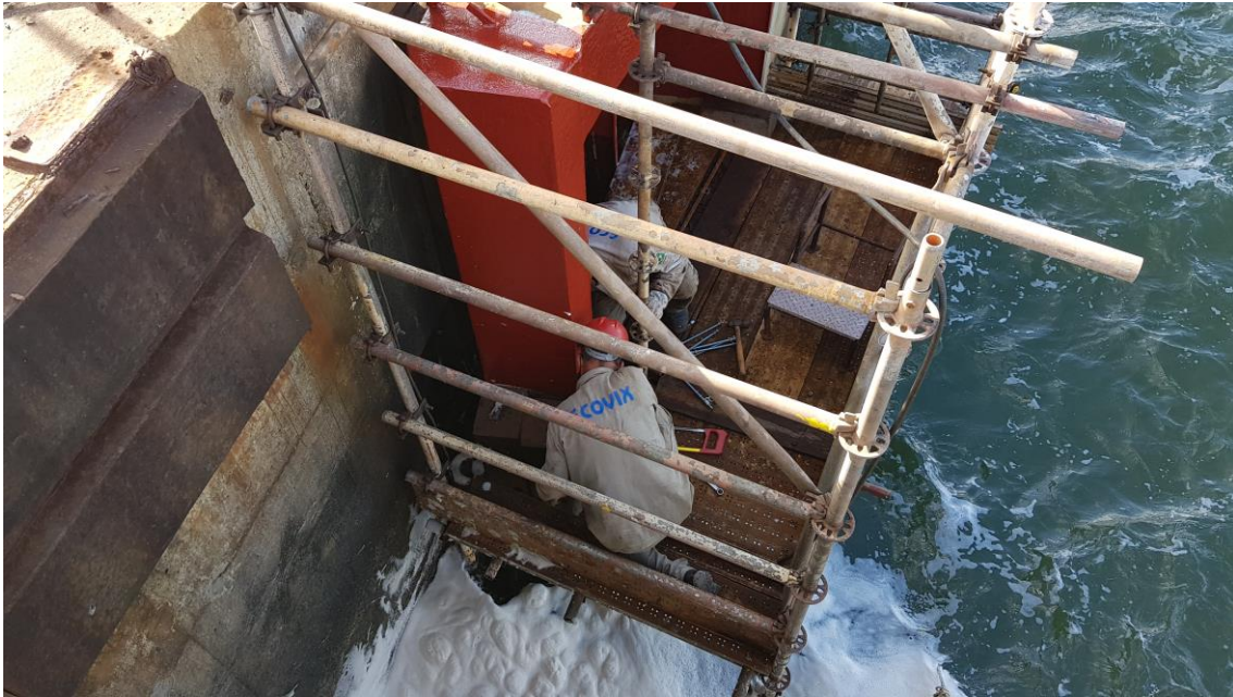
Manutenção Equipamentos – Porta Batel
