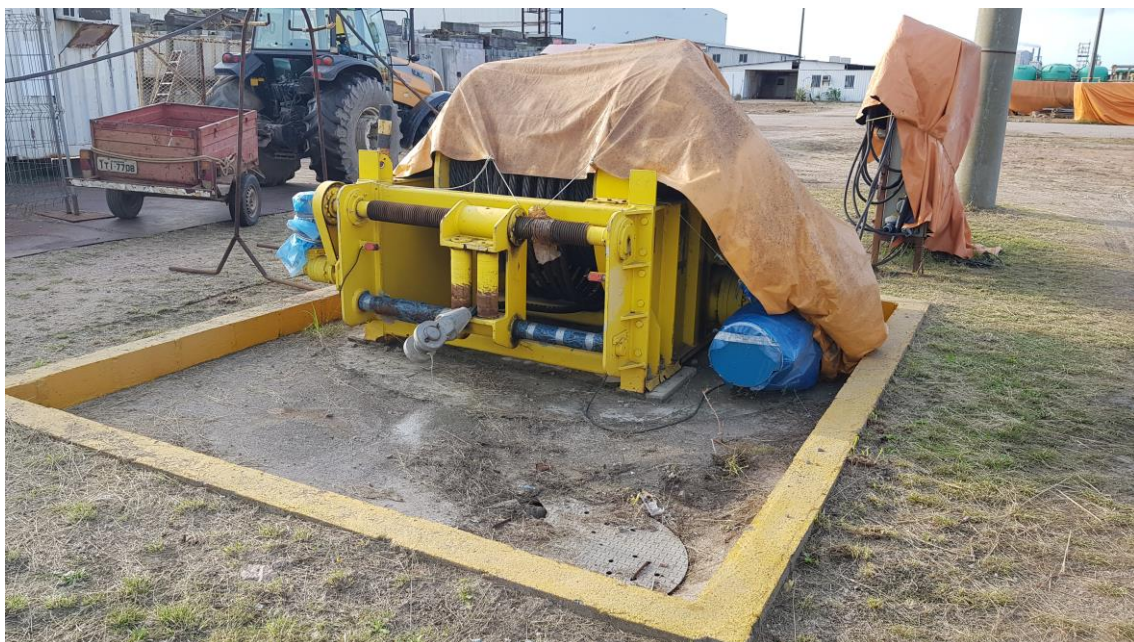
Manutenção Equipamentos – Guinchos
