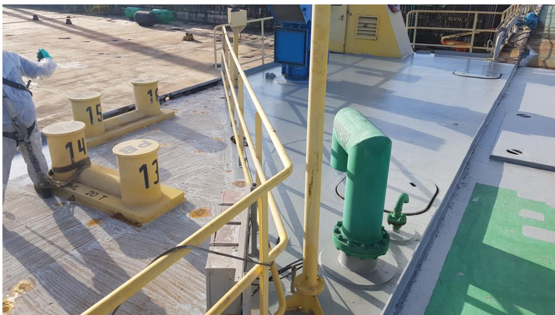
Manutenção Equipamentos – Porta Batel
