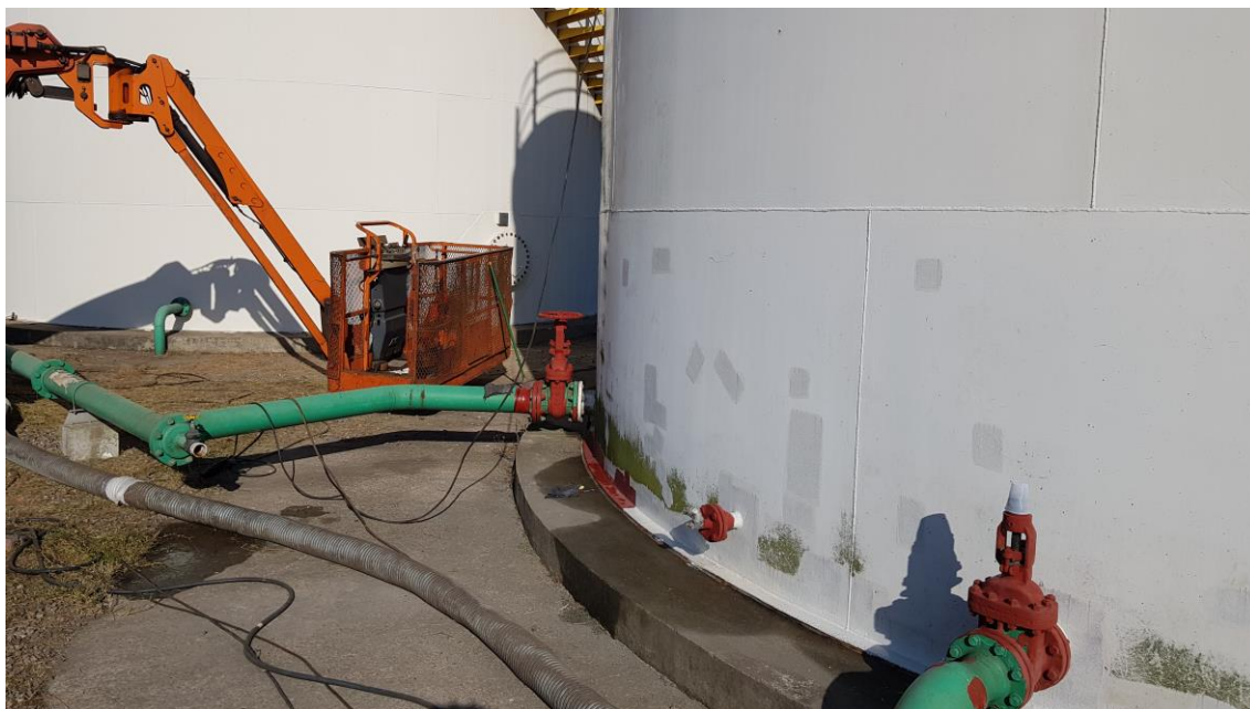
Manutenção Equipamentos – Tanques
