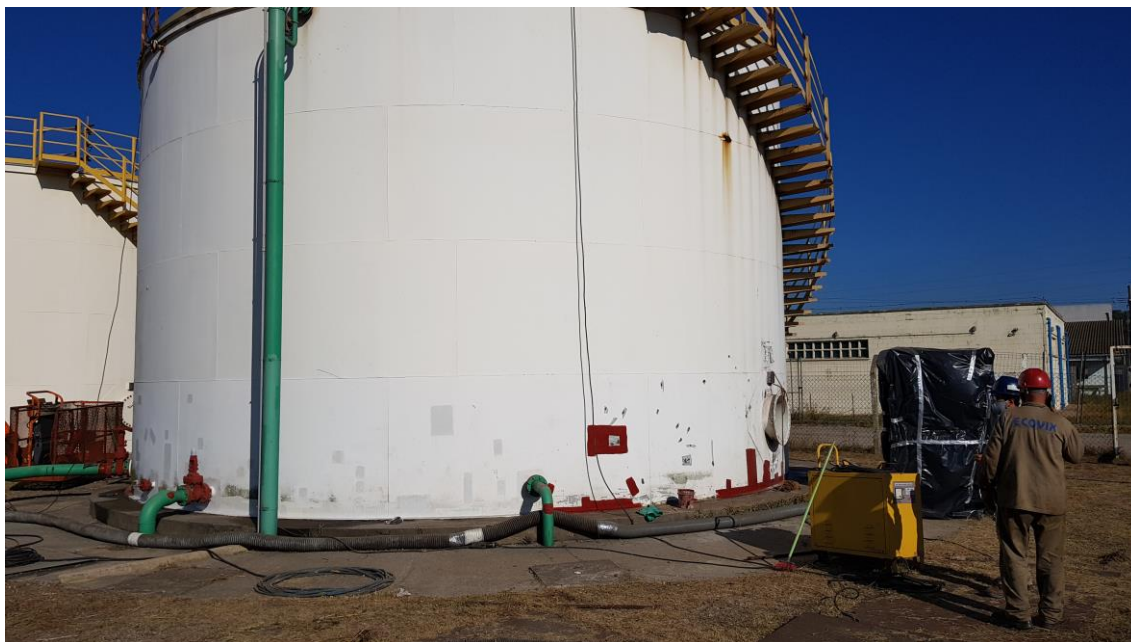
Manutenção Equipamentos – Tanques
