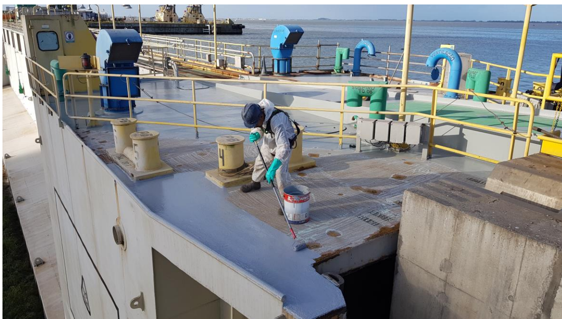
Manutenção Equipamentos – Porta Batel
