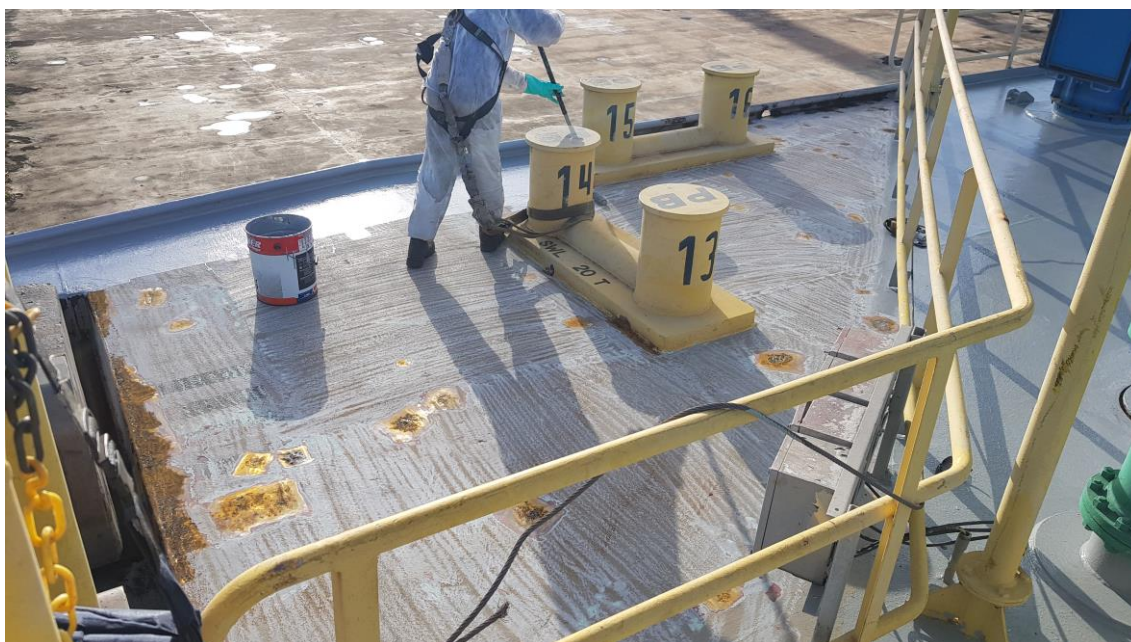
Manutenção Equipamentos – Porta Batel
