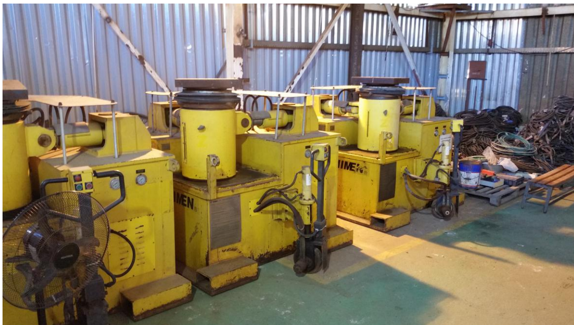
Manutenção Equipamentos Hidráulicos
