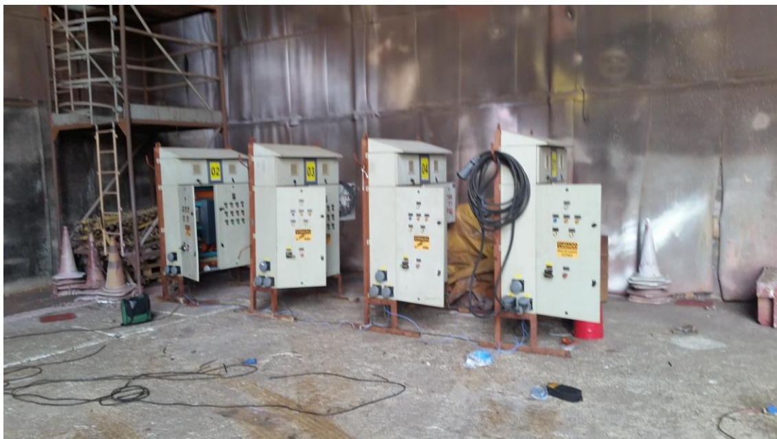
Manutenção Guinchos – Painéis
