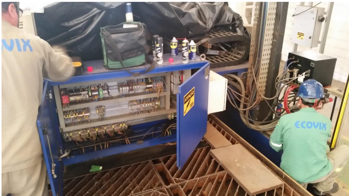
Manutenção Equipamentos Corte – Oficinas ERG 2
