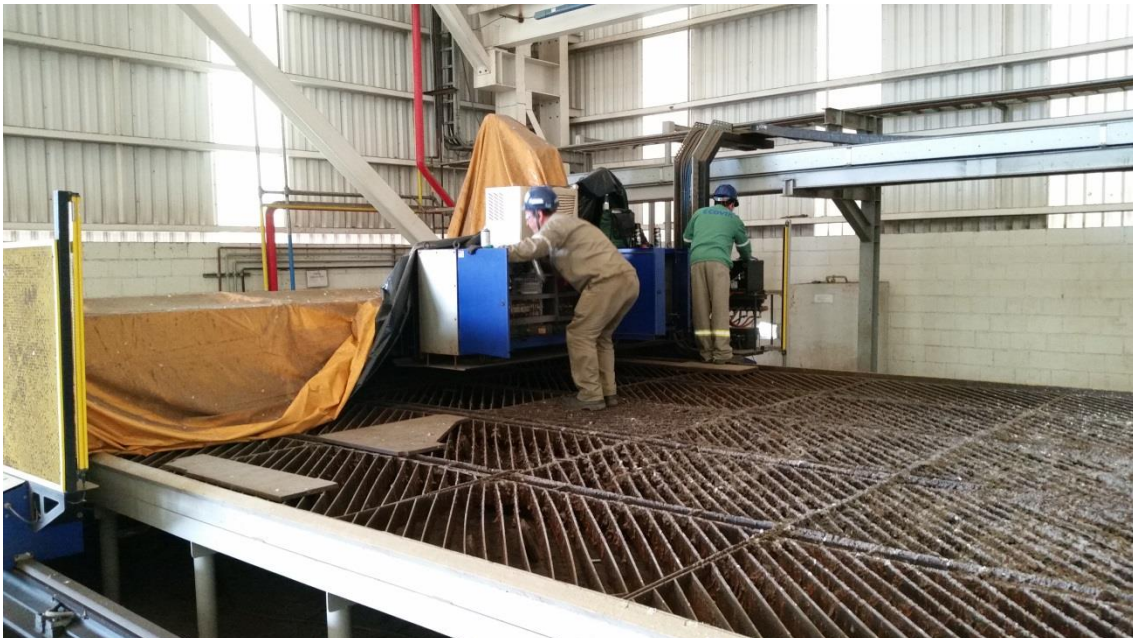
Manutenção Equipamentos Corte – Oficinas ERG 2
