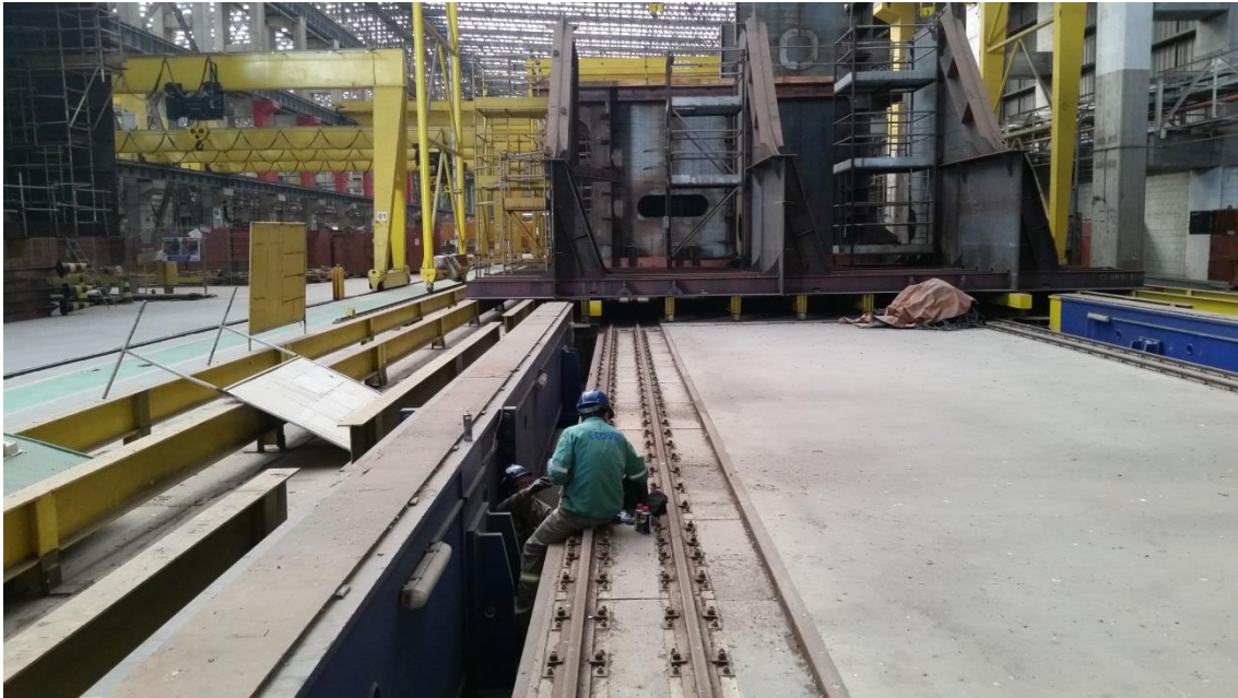
Manutenção Load-Out – Oficinas ERG 2
