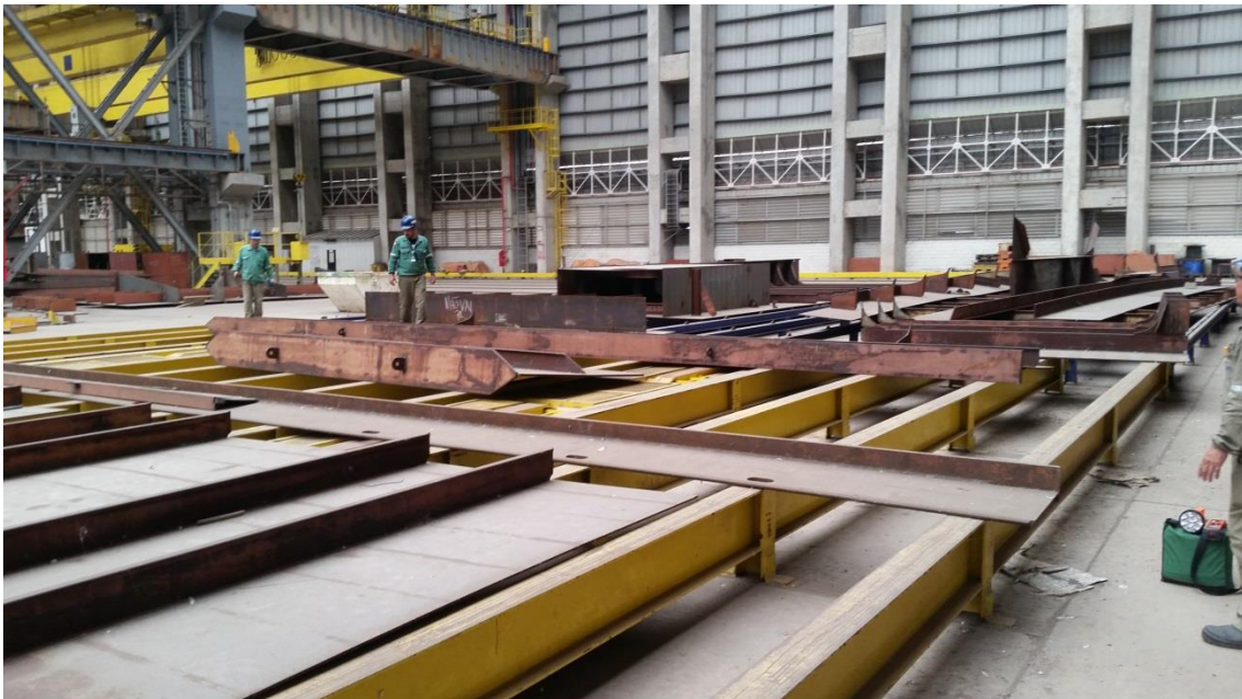
Manutenção Lift-Train – Oficinas ERG 2
