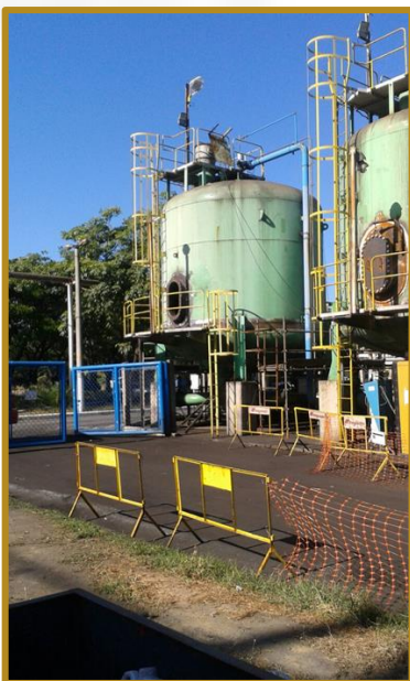
Vista Lateral do Filtro à Pressão
