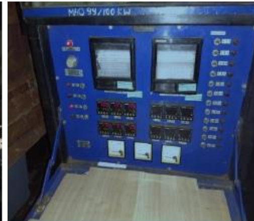
Controle do aquecimento
