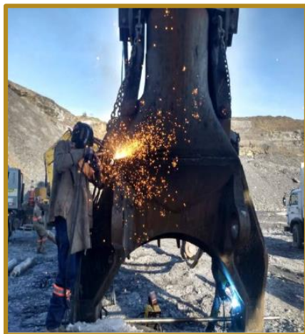
Processo de eliminação da trinca
