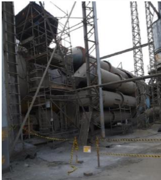
Vista do forno de cimento
