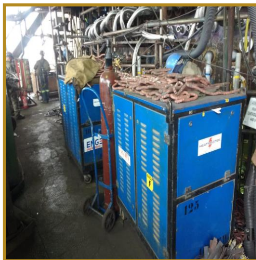
Equipamentos de Aquecimento na Plataforma do Alto-Forno.
