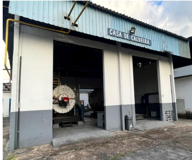
Casa de Caldeiras
