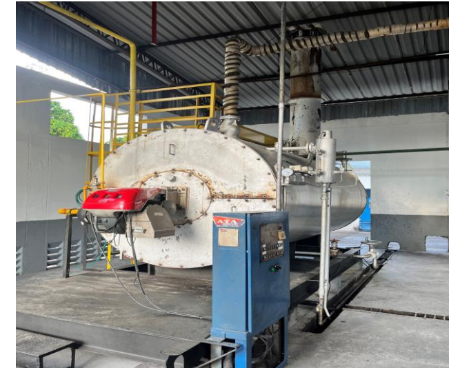
Caldeira a gás
