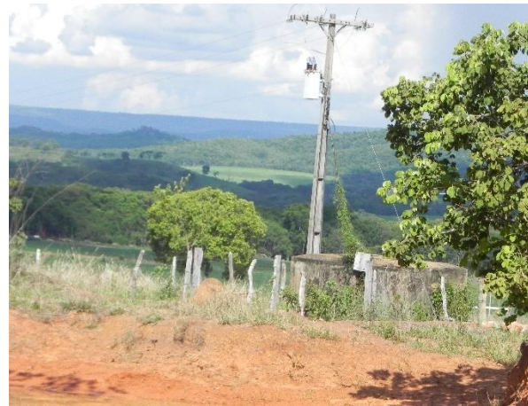
Rede elétrica Faz. Palmeiras
