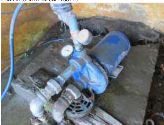
BOMBA PERIFERICA DE SUÇÃO DE ADITIVO
