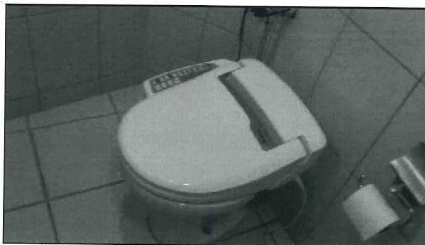
LAVABO – DETALHE DO APARELHO SANITARIO ELETRONICO
