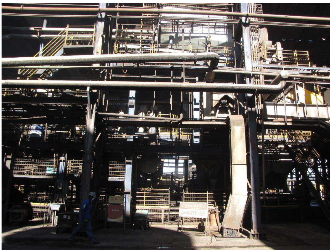
Foto 30 – Casa de máquinas
