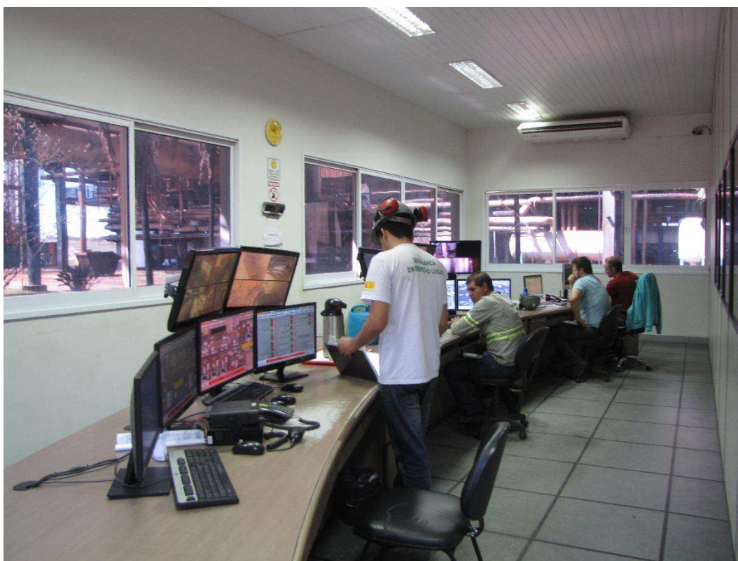
Foto 26 – Sala de controle industrial
