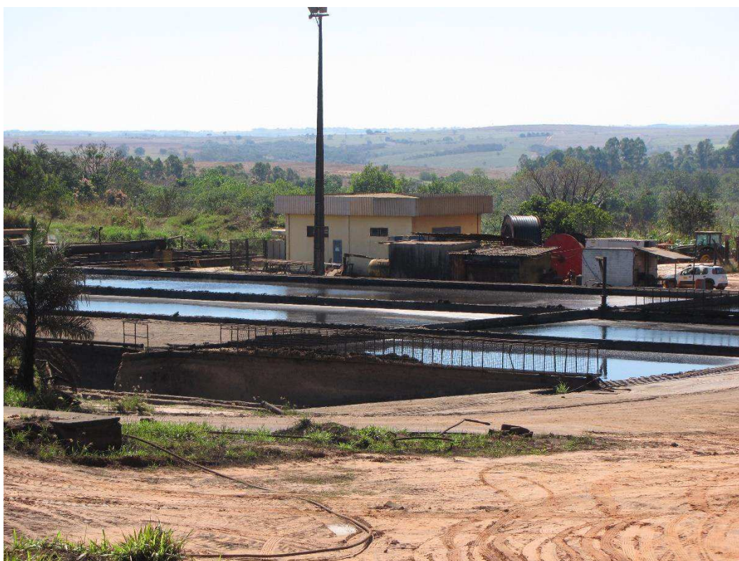
Foto 24 – Tanques de decantação vinhaça
