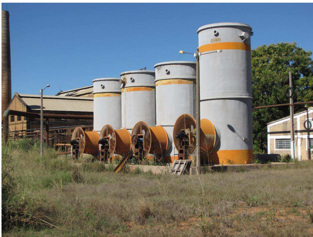
Foto 29 – Tanques de bombeamento
