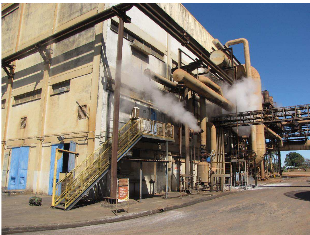
Foto 14 – Usina de Energia Elétrica
