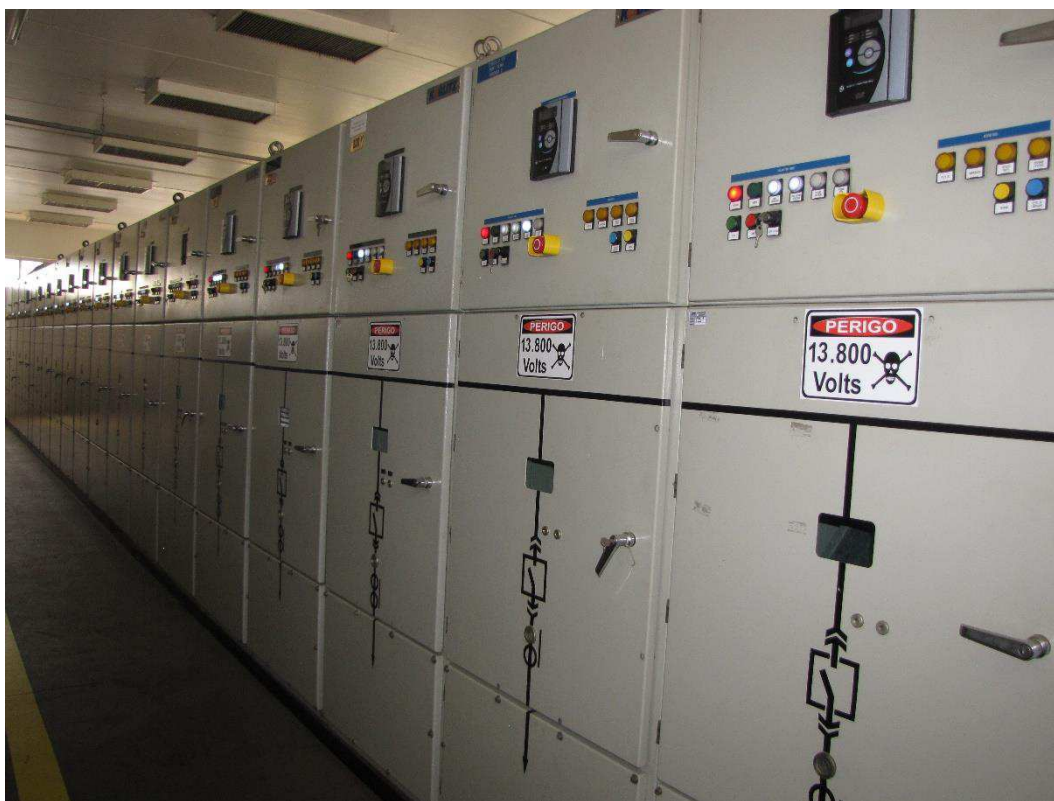
Foto 15 – Painéis de Controle
