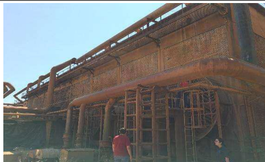
FOTO N. 20 TORRES DE RESFRIAMENTO
