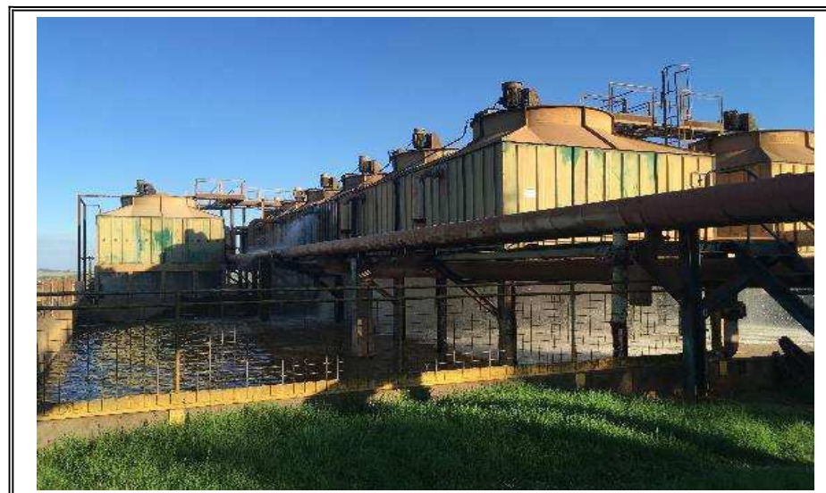
FOTO N. 20 TORRES DE RESFRIAMENTO
