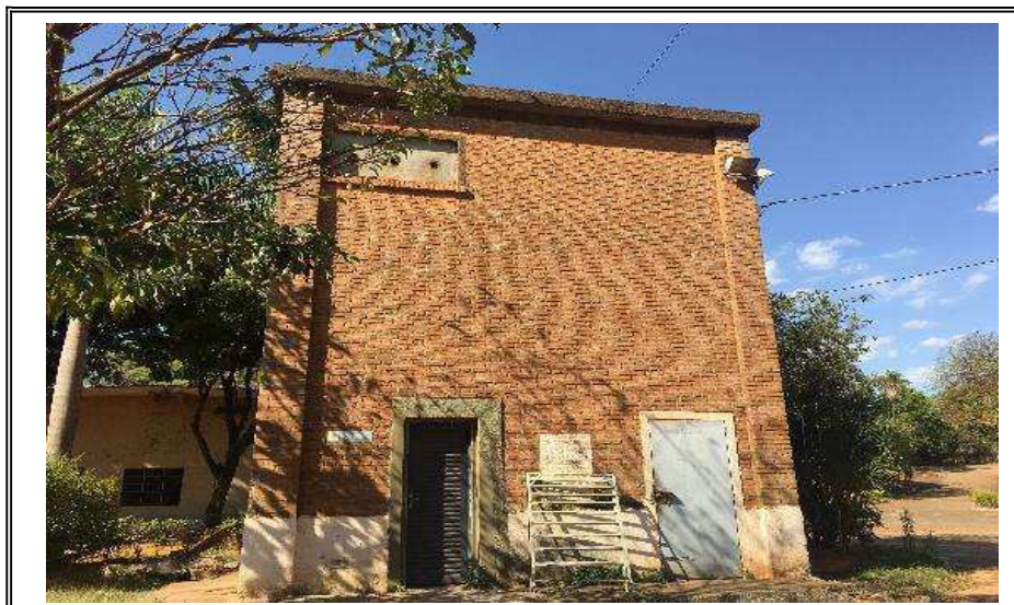
FOTO N. 1 SUBESTAÇÃO DE ENTRADA
