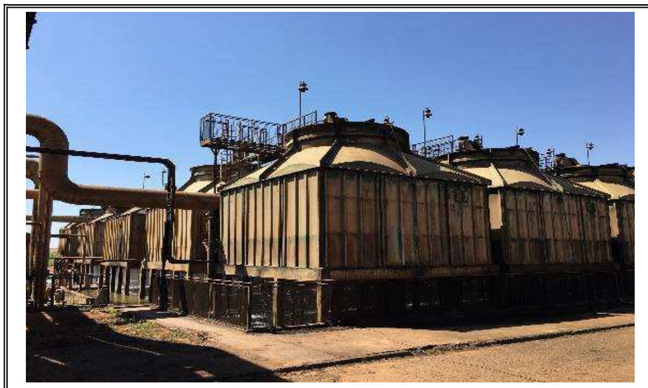
FOTO N. 21 TORRES DE RESFRIAMENTO
