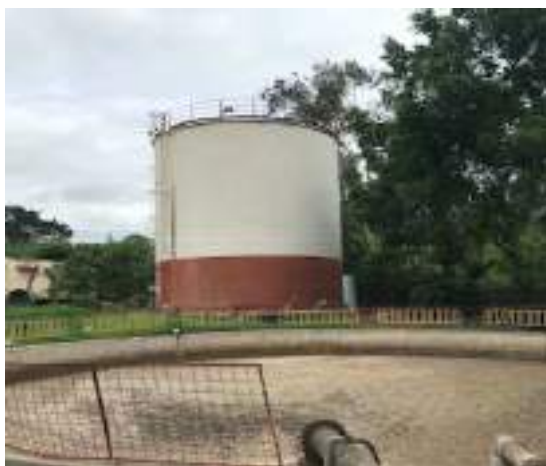
TANQUE DE EQUALIZAÇÃO / CAIXA D'AGUA
