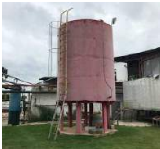
CAIXA D'AGUA PULMÃO DO FLOTADOR
