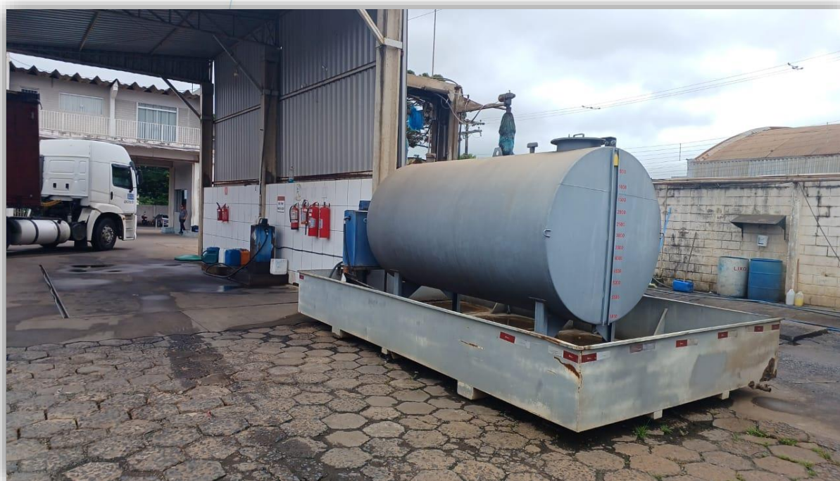
Foto 012: Tanque de armazenamento
