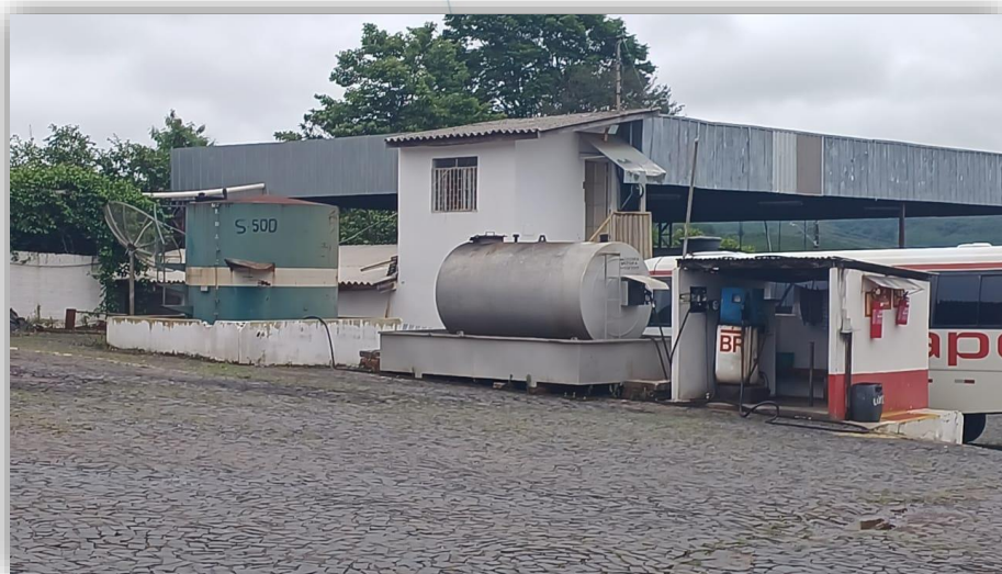
Foto 044: Tanque de armazenamento
