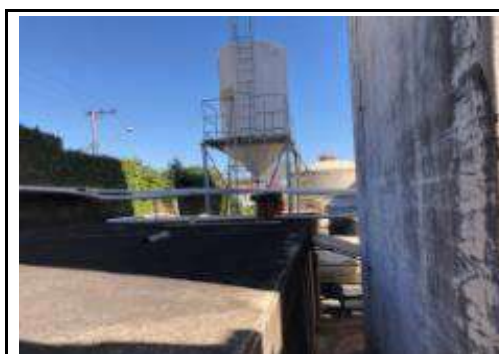
SIST DE TRATAMENTO EFLUENTES
