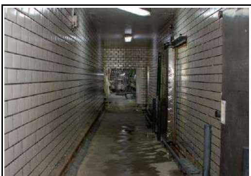
TUNEL DE CONGELAMENTO
