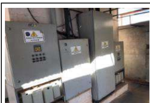
PAINEIS DE COMANDO
