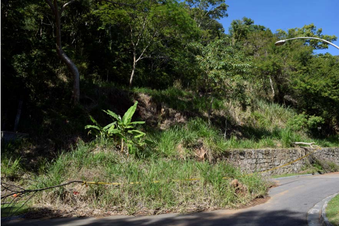
Foto 31: Área interditada pela Defesa Civil por ocorrência de deslizamento – Platô 4
