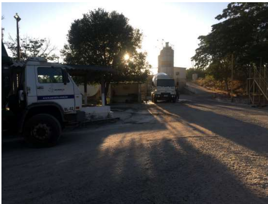
Foto 059: Pátio de Presidente Prudente com betoneiras e torre de cimento ao fundo.
