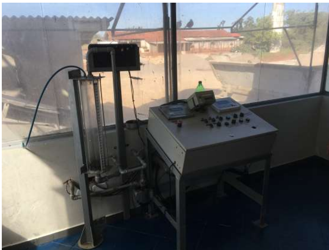
Foto 090: Sala de controle da torre de cimento e balança
