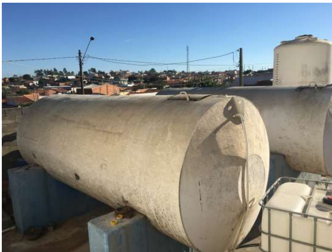
Foto 006: Tanques de armazenamento
