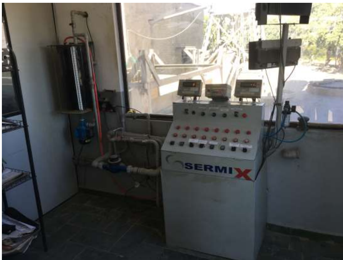
Foto 031: Sala de controle da torre de cimento e balança de materiais
