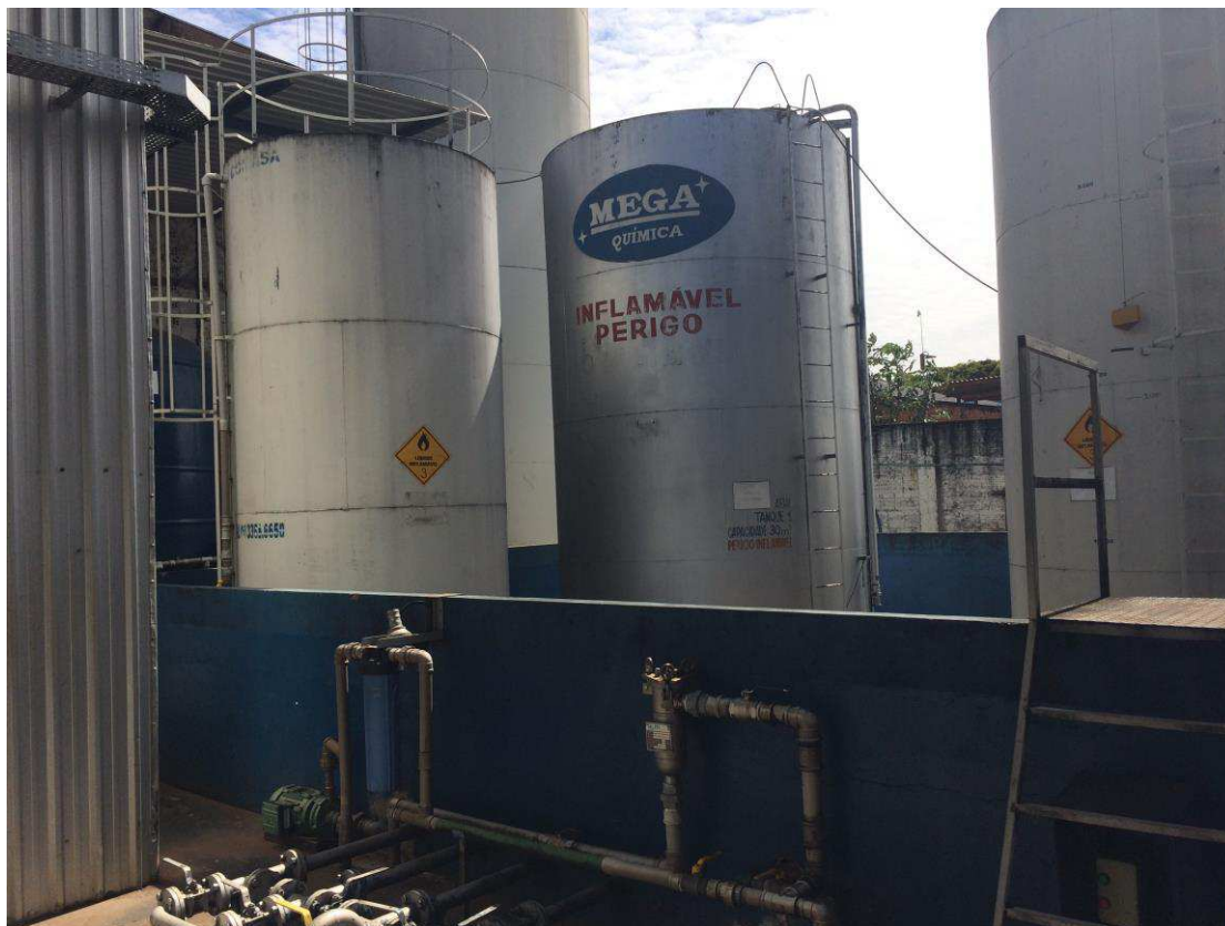
Foto 008: Tanques de armazenamento de álcool.
