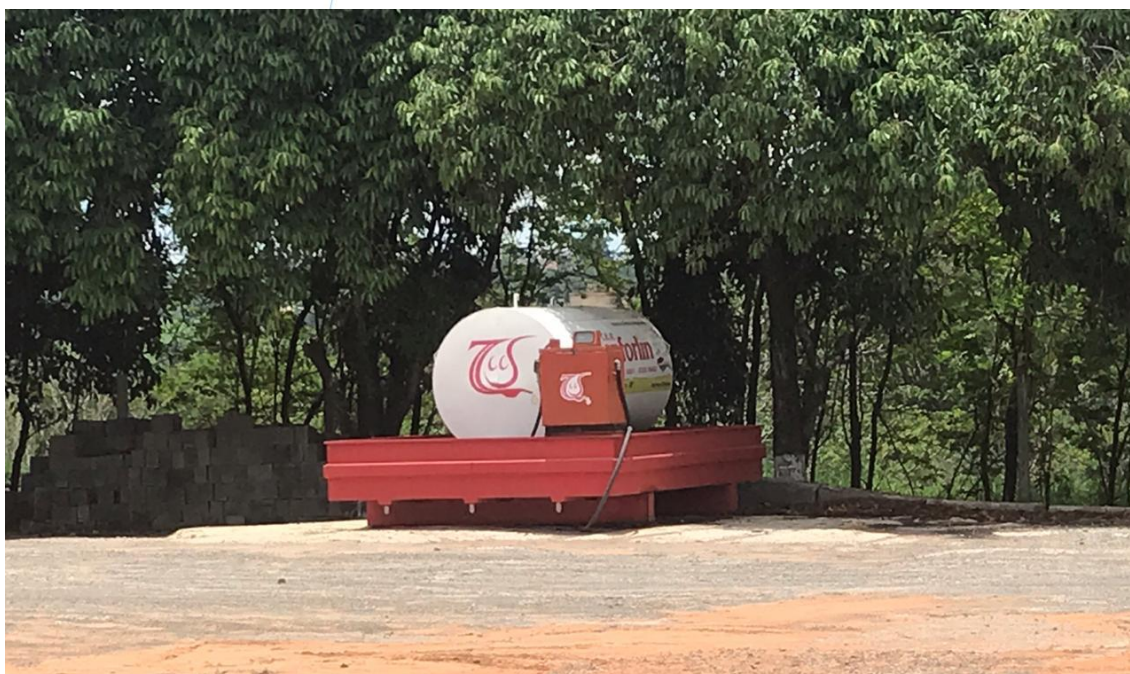
Foto 023: Tanque de combustível
