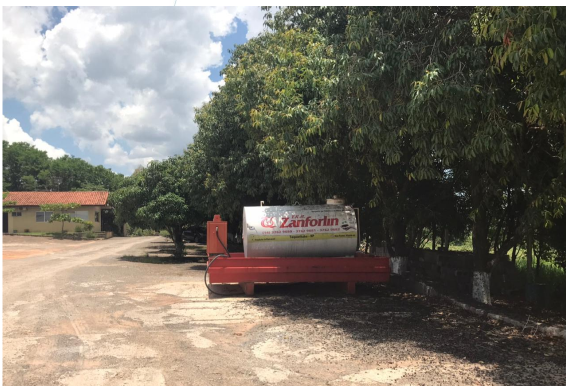
Foto 020: Tanque de combustível
