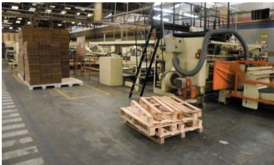
Foto 014: Maquinário operando normalmente (continuação)
