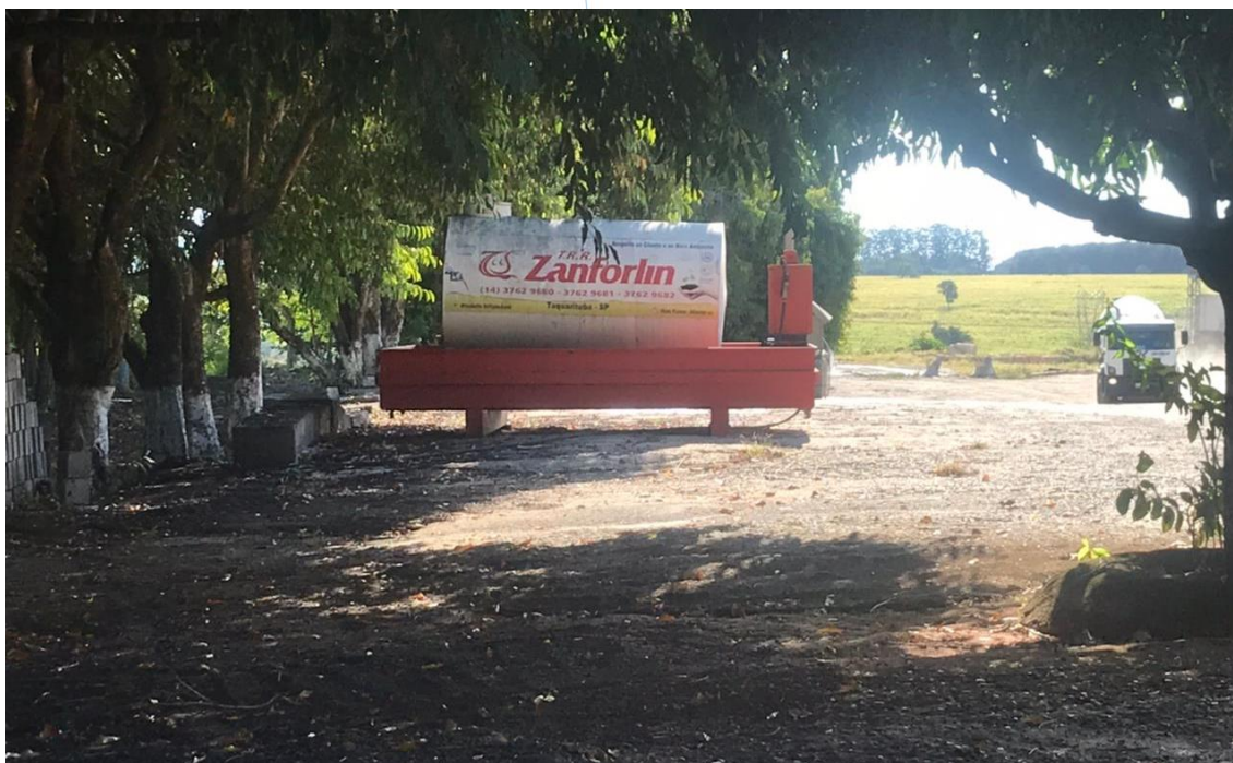
Foto 021: Tanque de combustível
