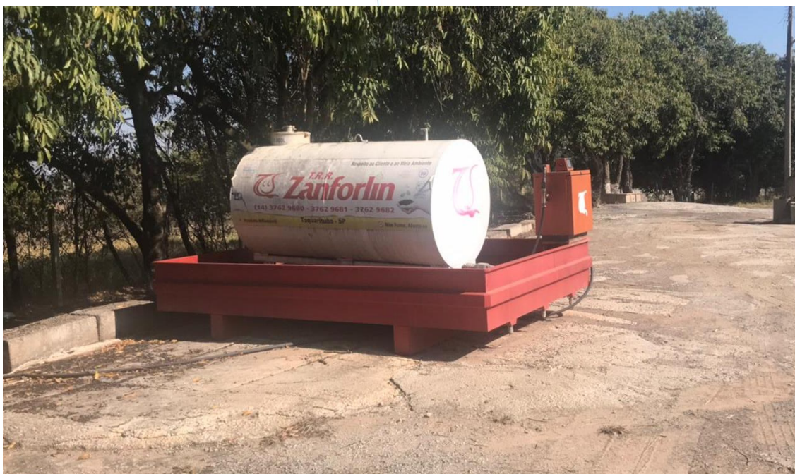
Foto 020: Tanque de combustível
