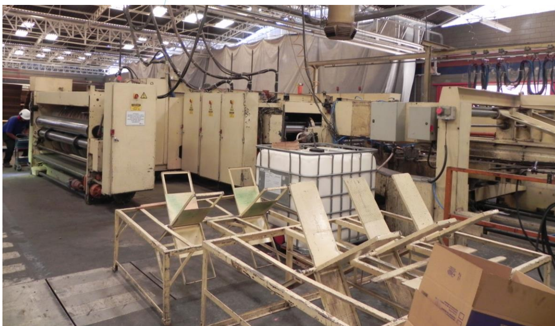
Foto 011: Maquinário operando normalmente
