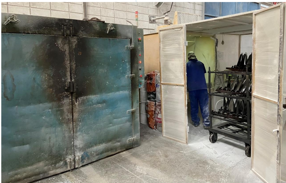
Foto 015: Câmara de pintura
