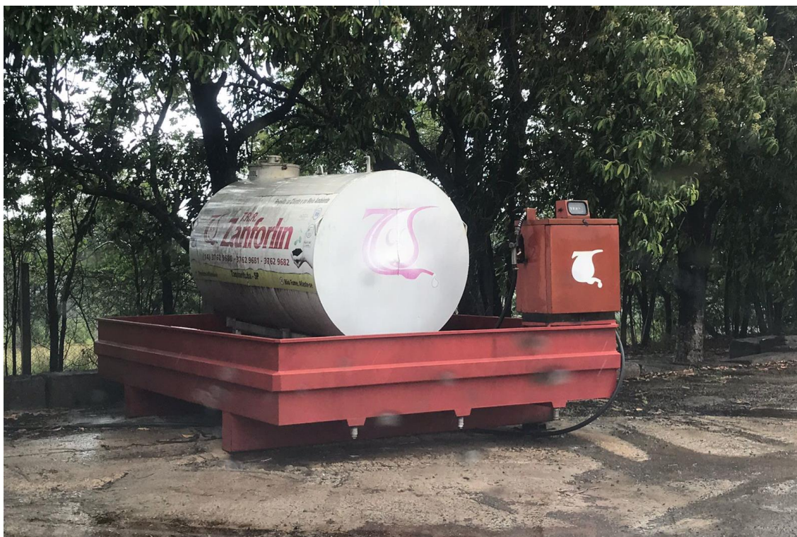
Foto 017: Tanque de combustível
