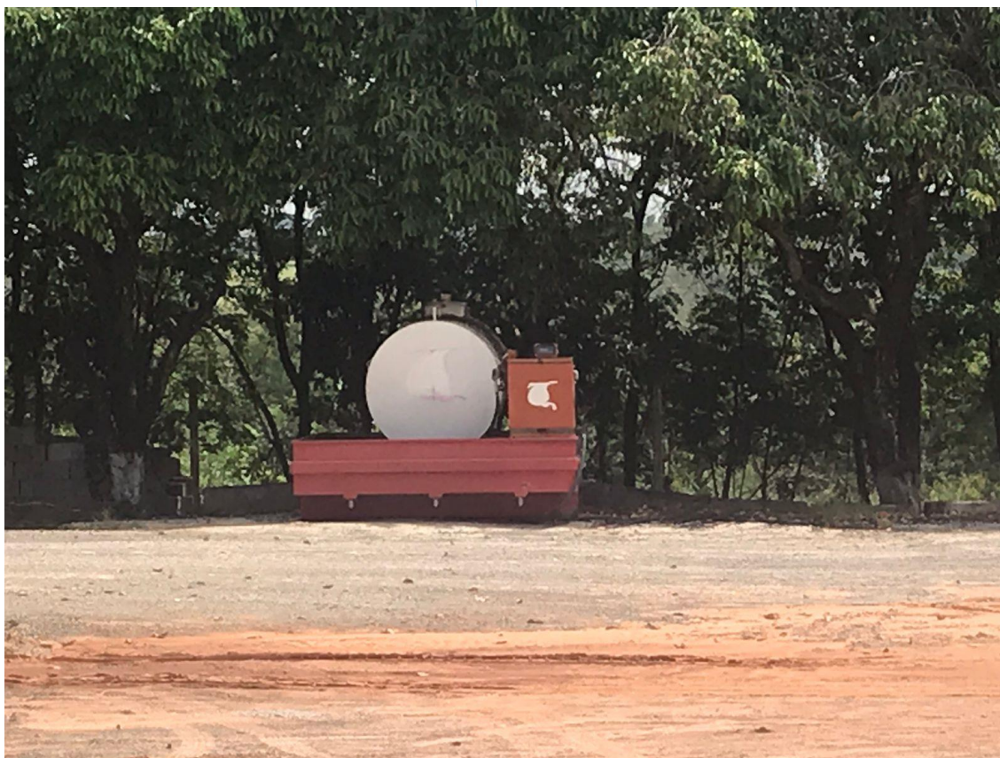
Foto 019: Tanque de combustível
