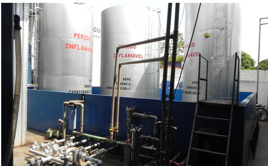
Foto 004: Depósito de inflamáveis
