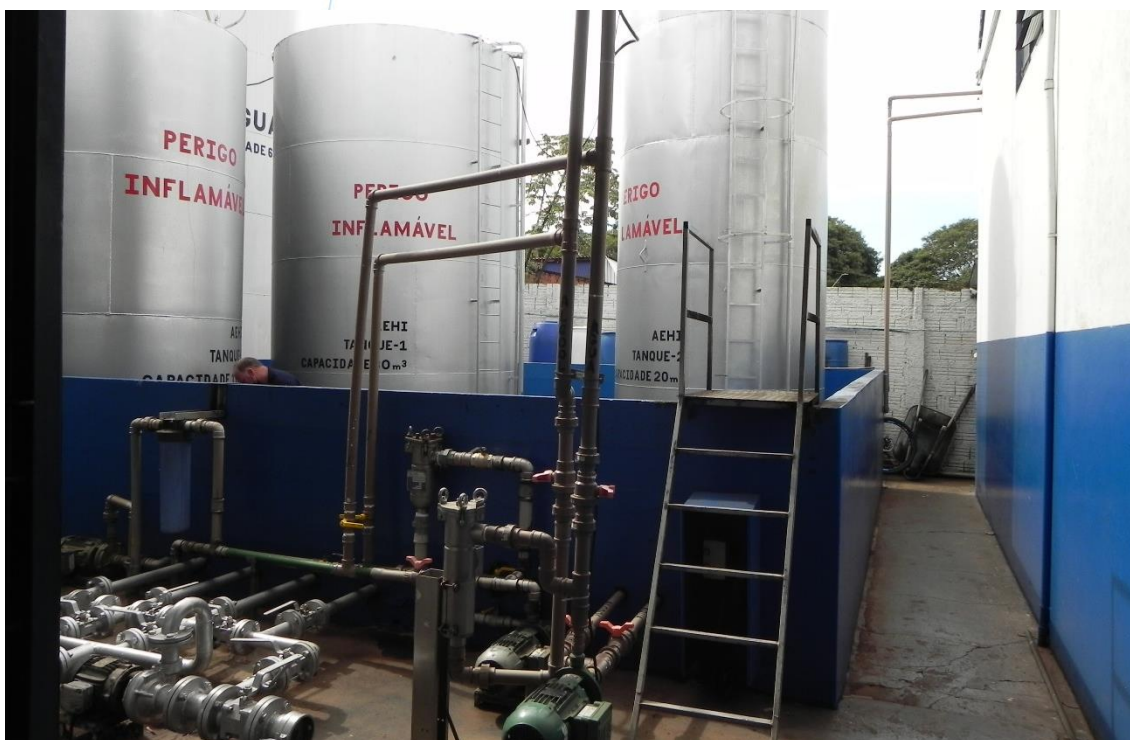
Foto 010: Depósito de inflamáveis
